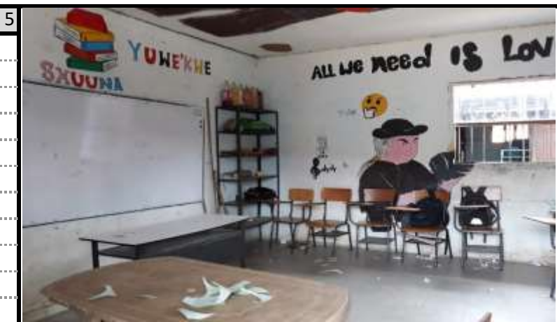
vista interior desprendimiento material cielo
