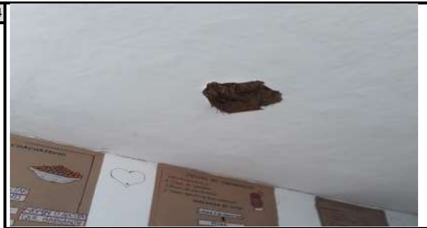
cielo en mal estado
