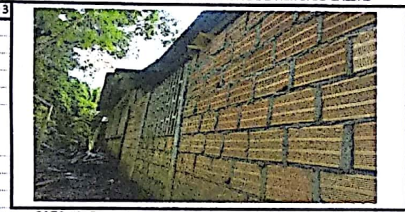
FOTO #3: EL SALON MUESTRA FACHADA Y MUROS INTERIORES SIN PAÑETES
