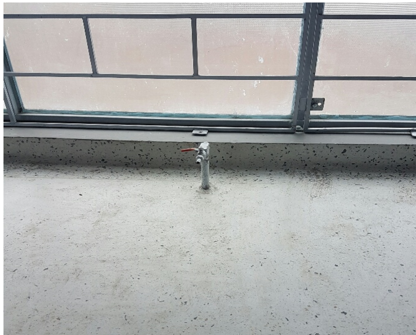
Foto 6. Salida para Mechero a gas GLP
