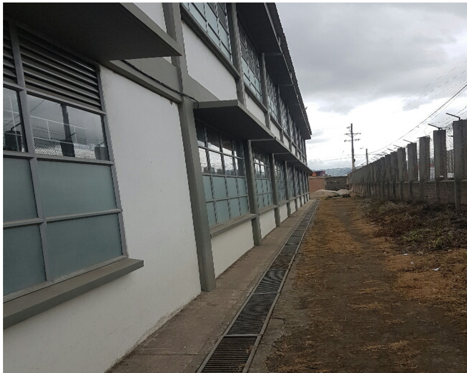
Foto 4. Rejillas de piso para recolección de aguas lluvia
