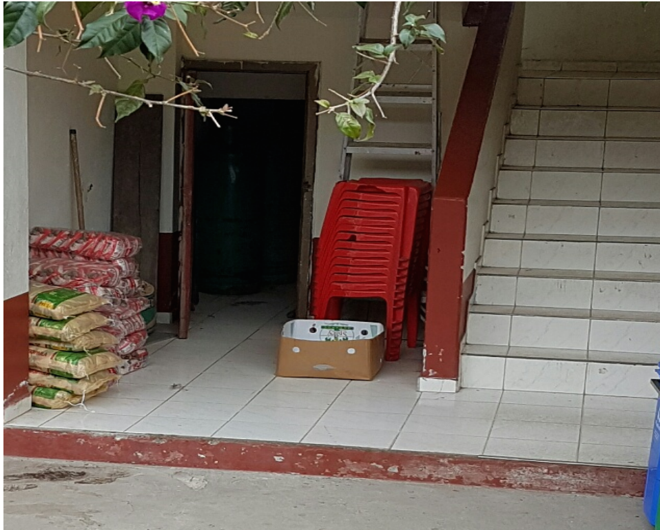
Foto 3. Localización de tanques de GLP para cocina, debajo de escalera.
