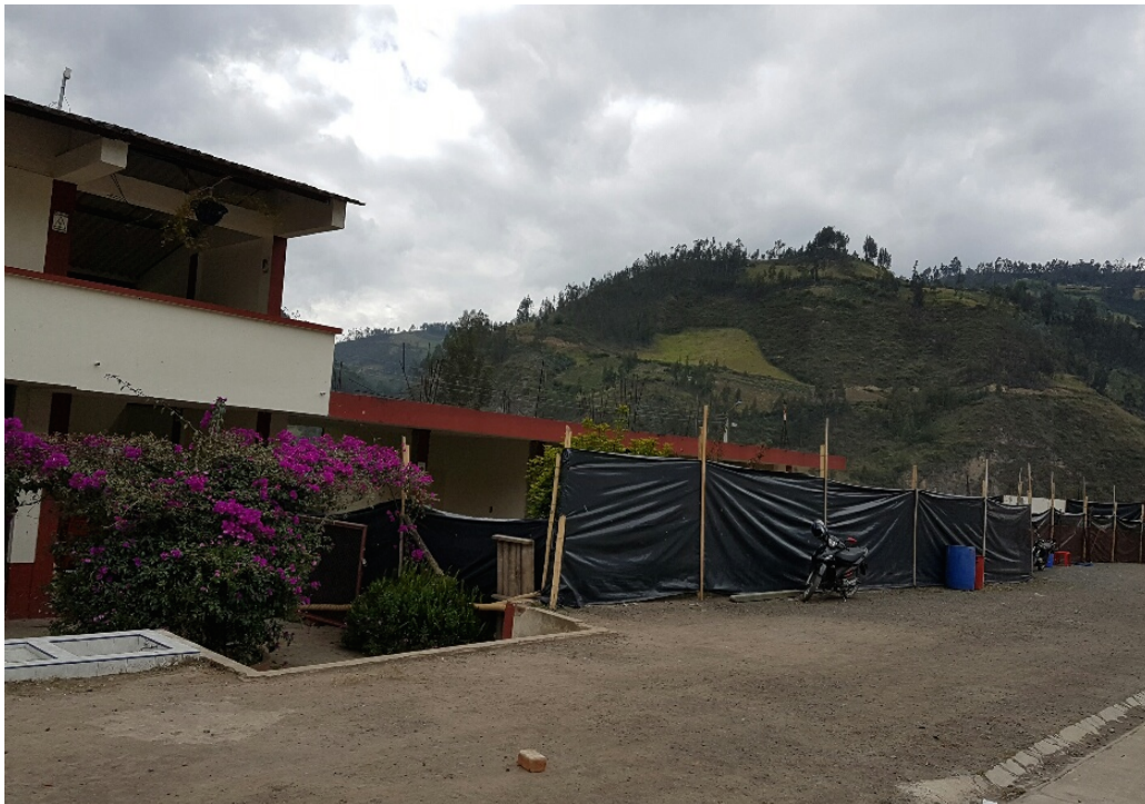
Foto 2. Evidencia de caída libre de aguas lluvias, y ubicación donde se realizarán los nuevos bloques.
