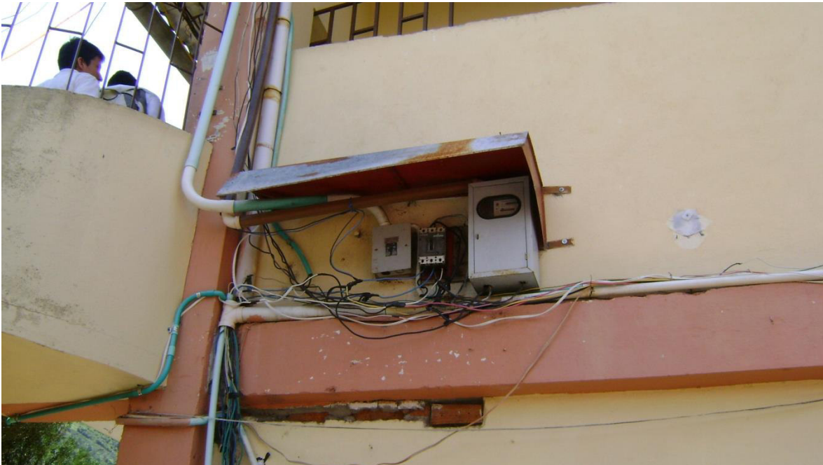
EQUIPO DE MEDIDA-TOTALIZADOR-TABLERO DOS CIRCUITOS.
