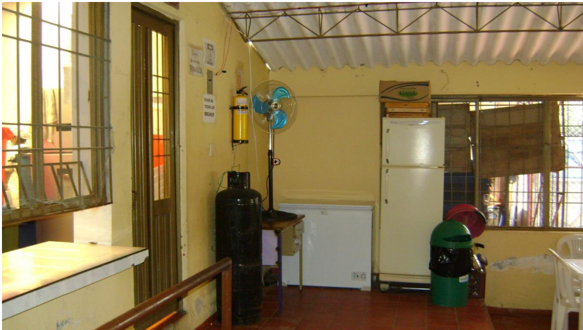
IMAGEN TABLERO DOS CIRCUITOS EMPOTRADO EN MURO PARTE SUPERIOR CILINDRO DE GAS.
