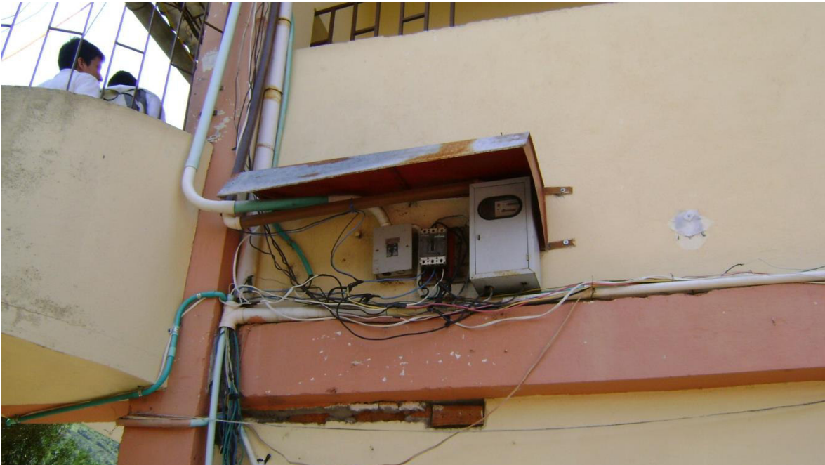
EQUIPO DE MEDIDA-TOTALIZADOR-TABLERO DOS CIRCUITOS.
