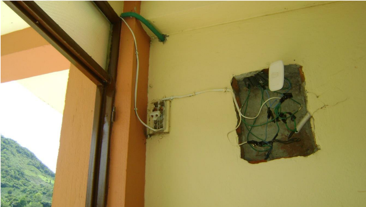
IMAGEN DE CIRCUITO PROTEGIDA CON CUCHILLA –SIN INSTALAR CAJA DE PASO.
