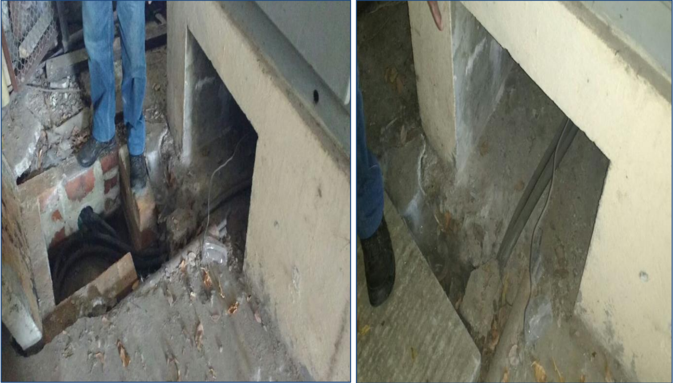
ACOMETIDA ALIMENTACION TRANSFORMADOR
