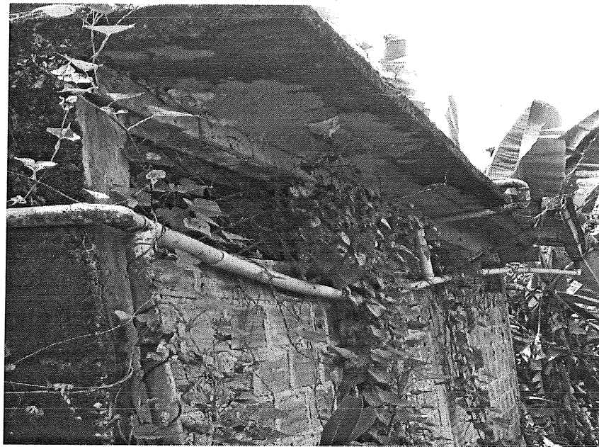
Foto 4. Estado de conexiones de aguas lluvia hacia tanque.
