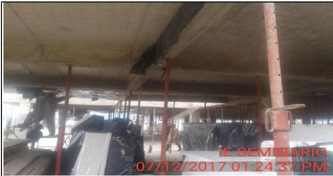
FOTO 12: Se baja formaleta (icopor) de tramo fundido de losa de entrepiso nivel 1 a los 10 días, sin tener resultados de cilindros a los 7 días.
