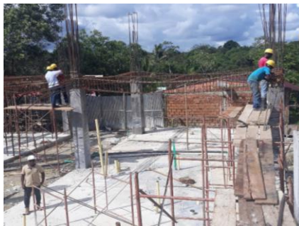
TRABAJOS INSEGUROS EN ALTURA.
