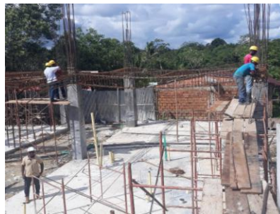
TRABAJOS INSEGUROS EN ALTURA.
