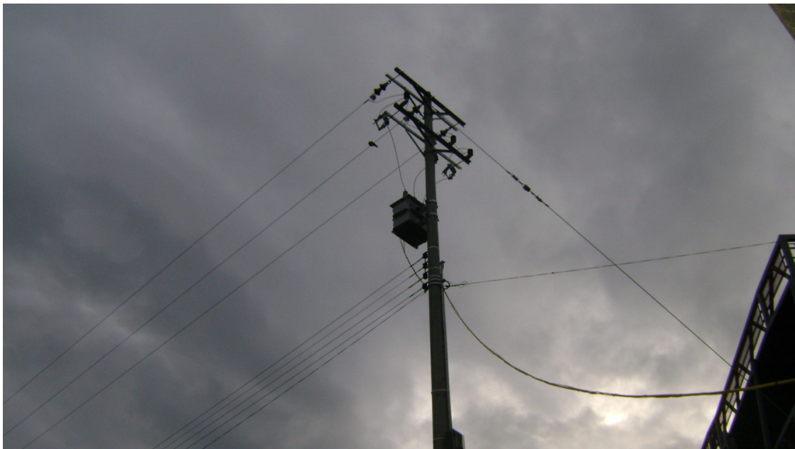
IMAGEN ESTRUCTURA PARA RED DE MEDIA TENSIÓN.
