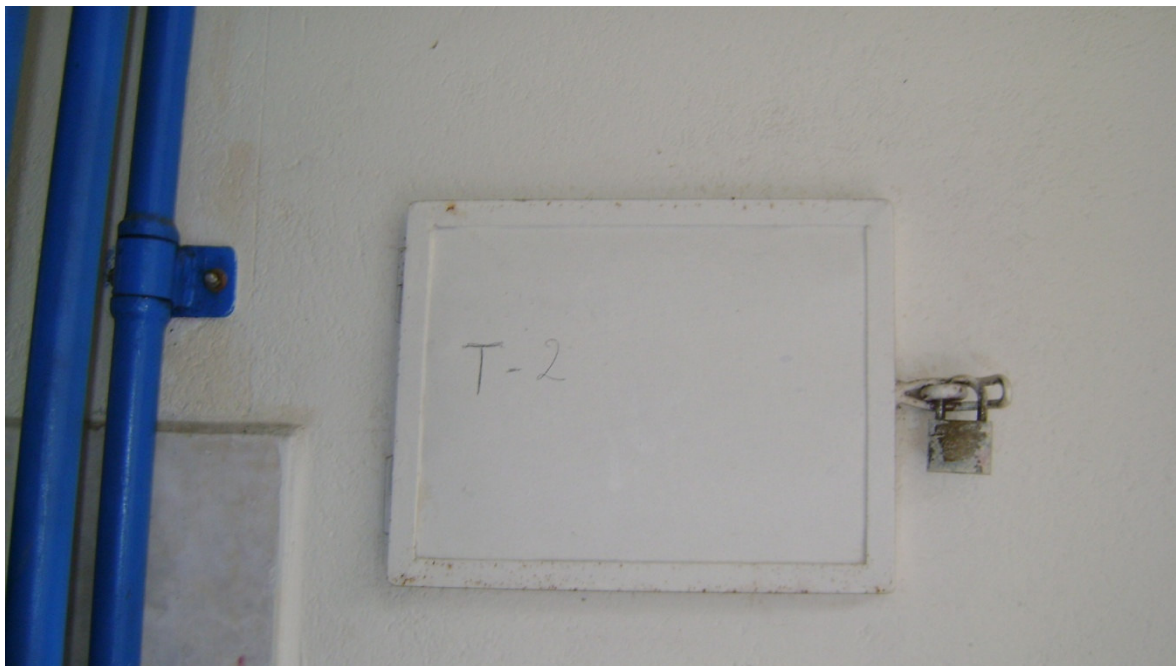
IMAGEN TABLERO MONOFÁSICO 3CTS. UBICACIÓN PREESCOLAR.
