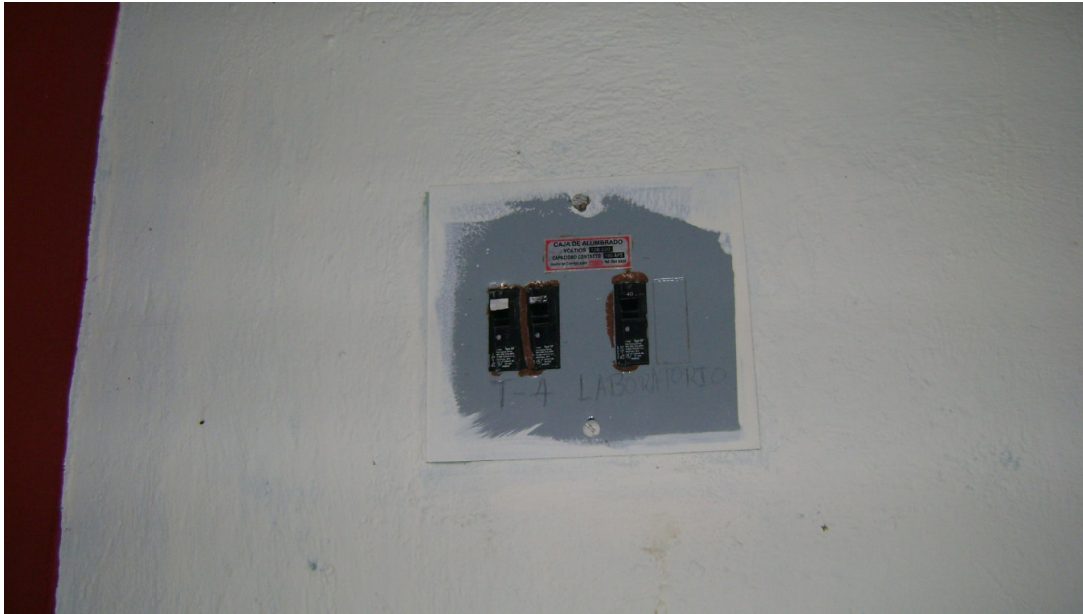
IMAGEN TABLERO MONOFÁSICO 4 CTS. UBICACIÓN LABORATORIO QUÍMICA.
