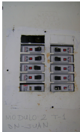
IMAGEN TABLERO TRIFÁSICO 12 CTS.
