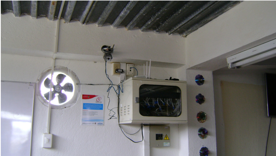
IMAGEN TABLERO AULA DE INFORMÁTICA. TABLERO 1 BLOQUE 2.
