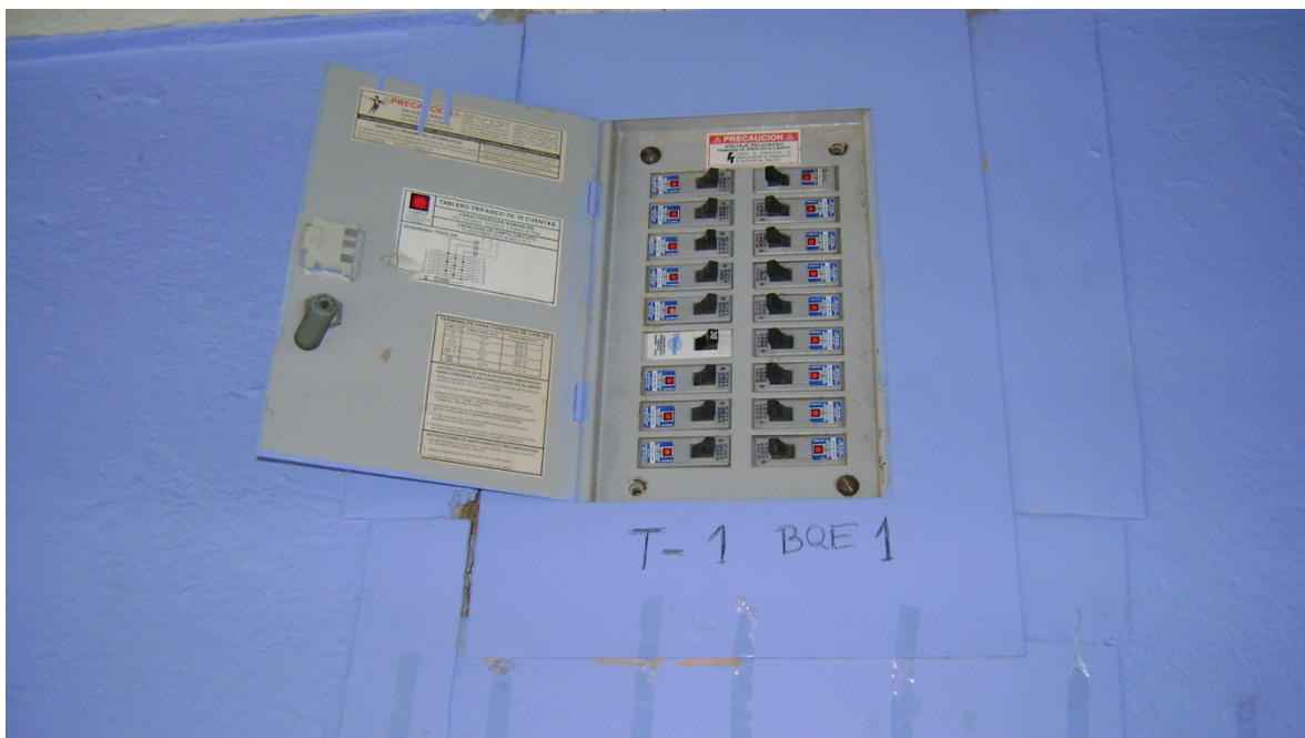
IMAGEN TABLERO 225A TRIFÁSICO 18 CTS BLOQUE 1.
