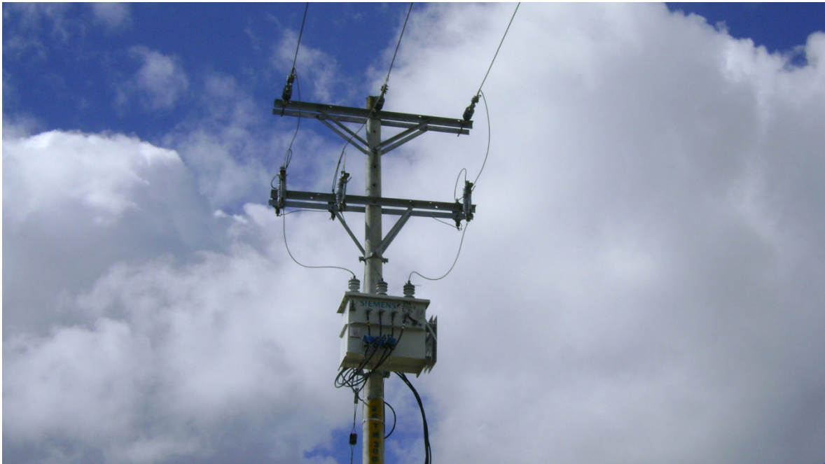
EN LA IMAGEN SE OBSERVA LOS TRES ELEMENTOS DE MEDIDA (T C) 150/5.
