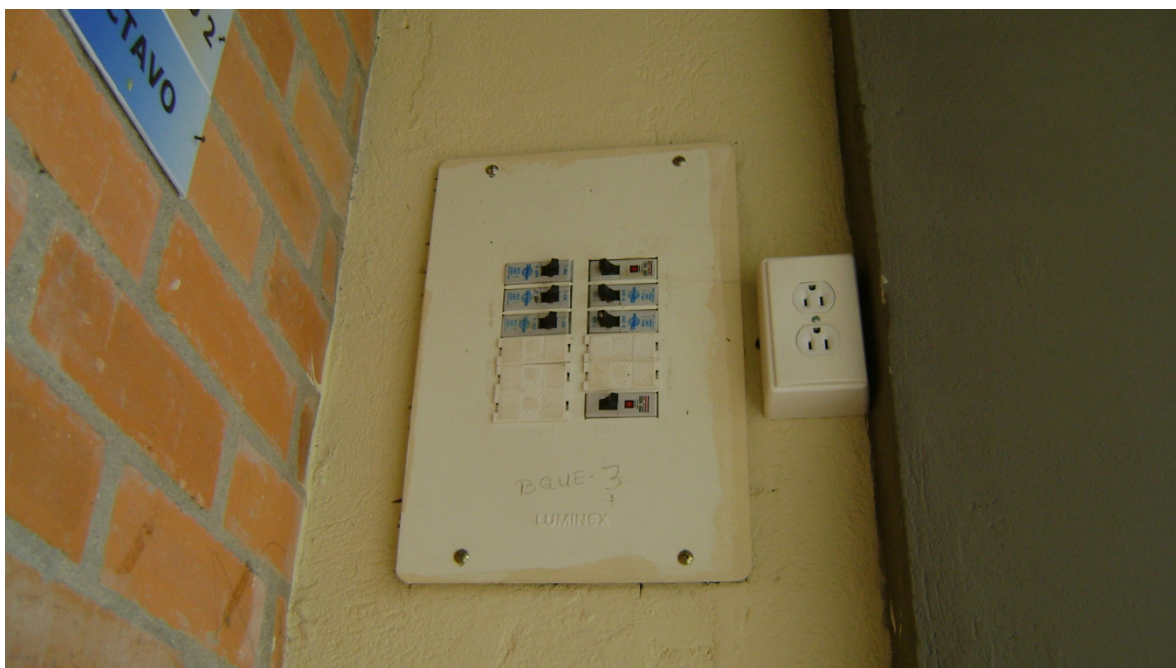
IMAGEN TABLERO TRIFÁSICO 12 CTS. BLOQUE 3
