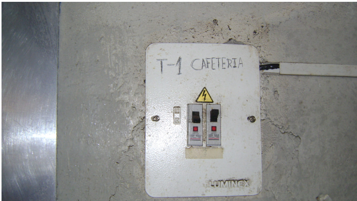
IMAGEN TABLERO MONOFÁSICO 2 CIRCUITOS ZONA DE CAFETERIA TIENDA ESCOLAR.
