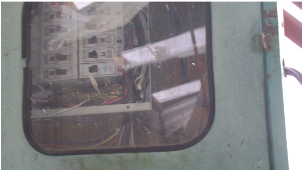
IMAGEN TABLERO TRIFÁSICO 12 CTS TRIBUNA COLISEO.
