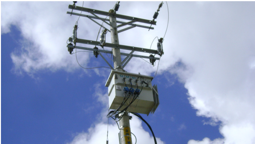
IMAGEN 1 ESTRUCTURA RED MEDIA TENSIÓN.
