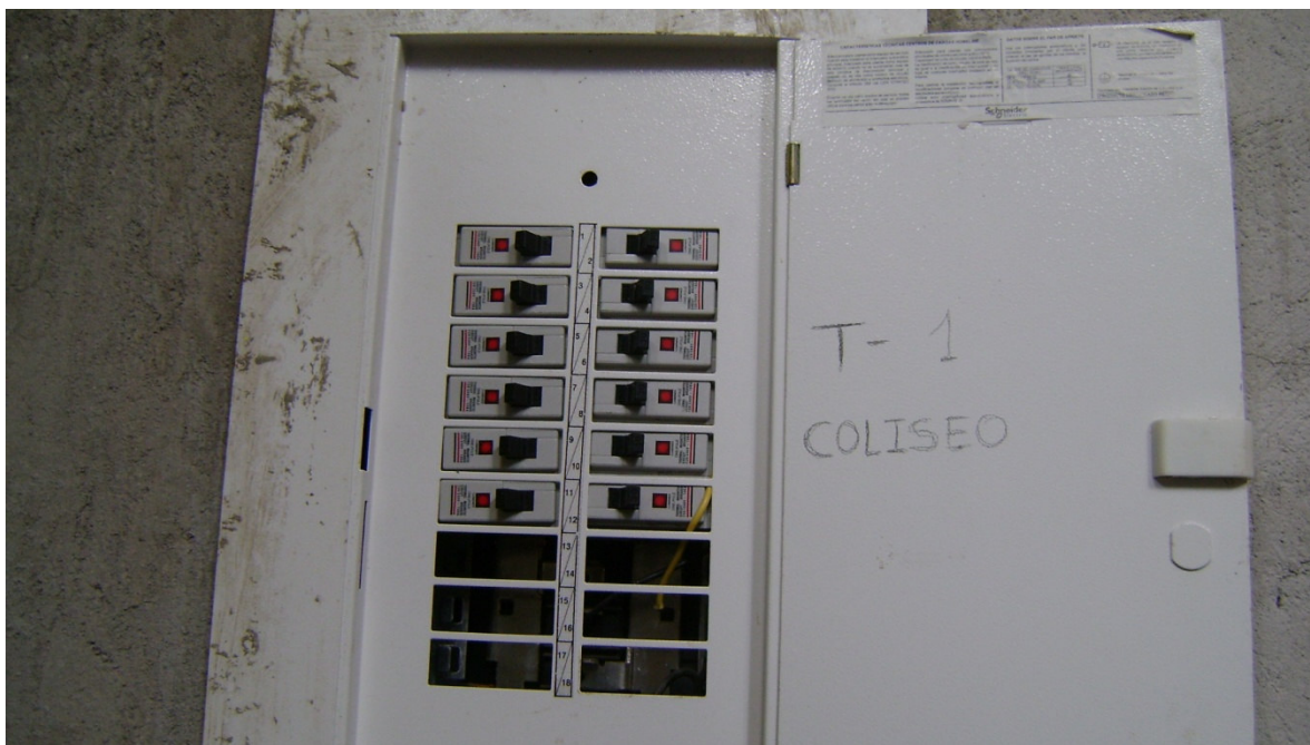
IMAGEN TABLERO TRIFÁSICO 18 CTS COLISEO.
