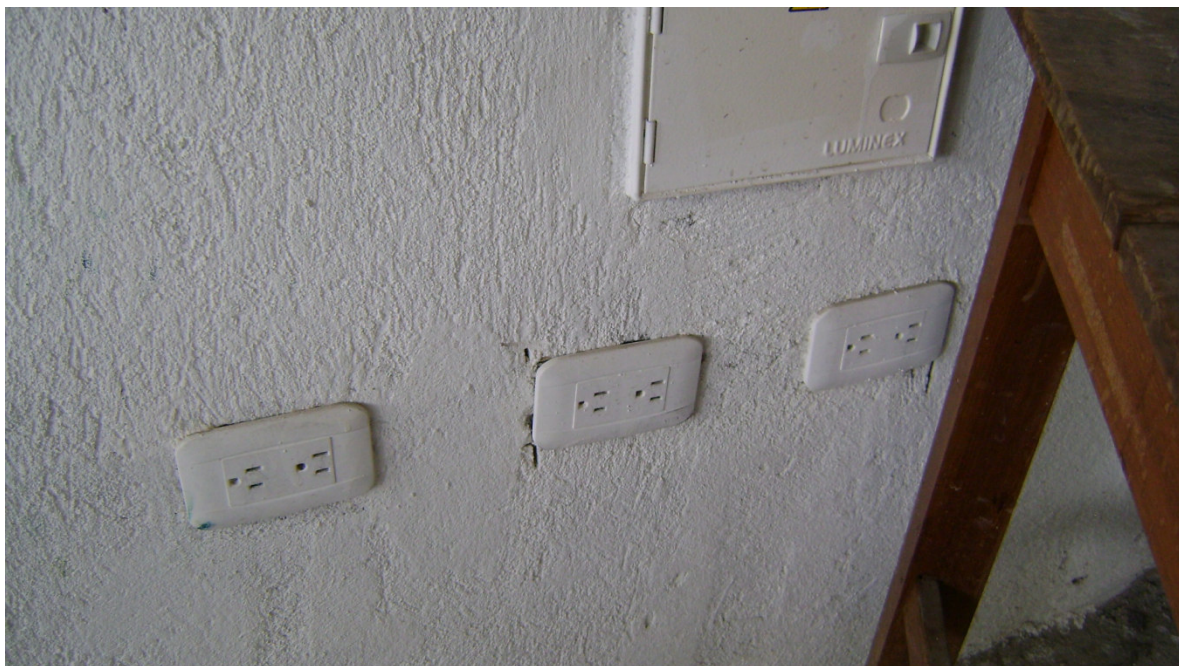
IMAGEN TABLERO MONOFÁSICO 4 CTS AUDITORIO.
