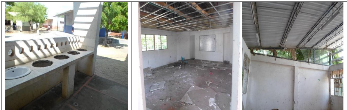
Fotografía 1. Estado actual Infraestructura Educativa.
