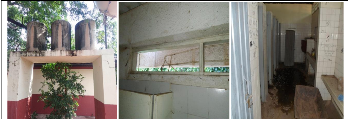
Fotografía 1. Estado actual Infraestructura Educativa.
