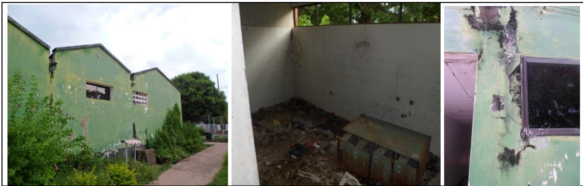
Fotografía 1. Estado actual Infraestructura Educativa.
