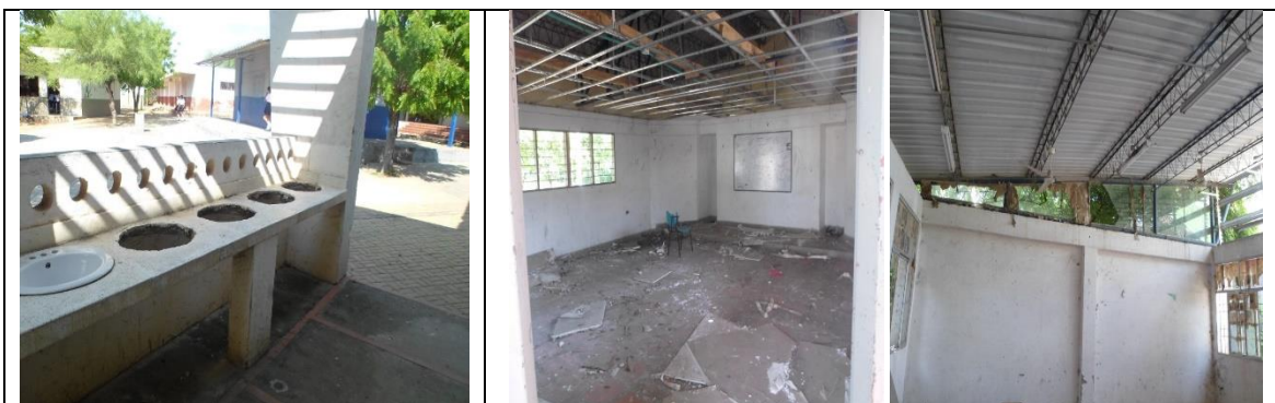
Fotografía 1. Estado actual Infraestructura Educativa.
