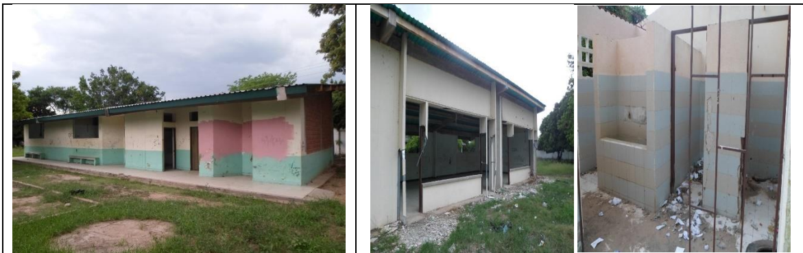
Fotografía 1. Estado actual Infraestructura Educativa.
