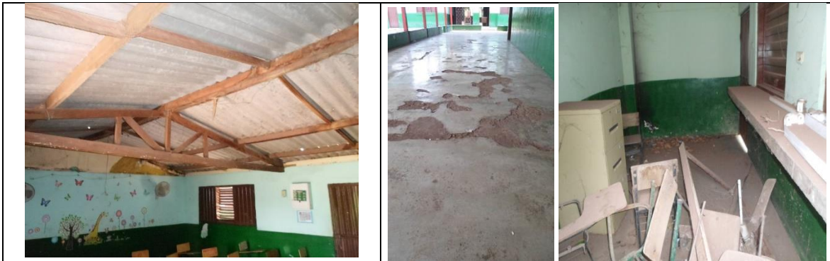
Fotografía 1. Estado actual Infraestructura Educativa
