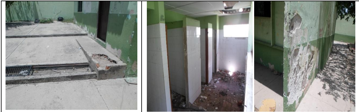
Fotografía 1. Estado actual Infraestructura Educativa.
