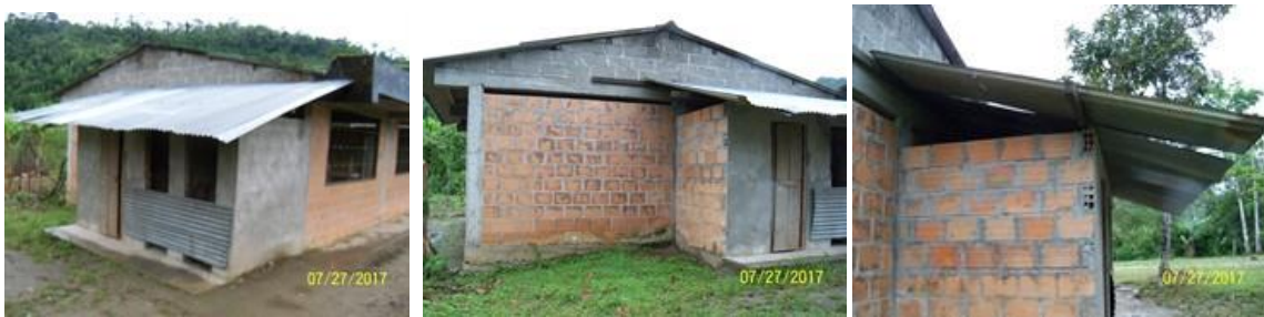
Batería de baños existentes y a reponer.
