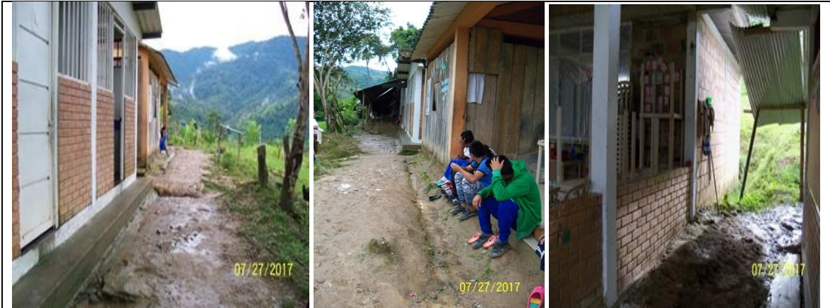
Área disponible para la circulación cubierta, la cual comunicará los módulos de dormitorio niñas, batería baños, comedor, dormitorio niños y cocina
