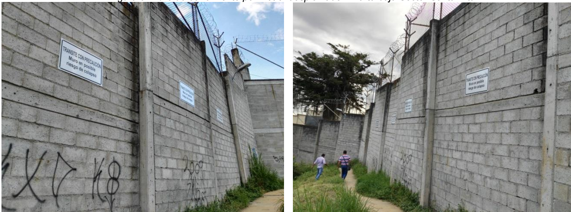
Figura 6. Tramos de muro de cerramiento perimetral desplomados.
