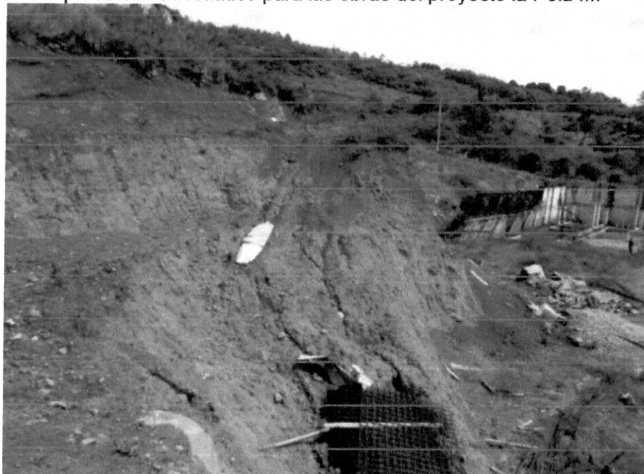
Imagen 28 Tierras desnudas (taludes con alto grado de erosión)
