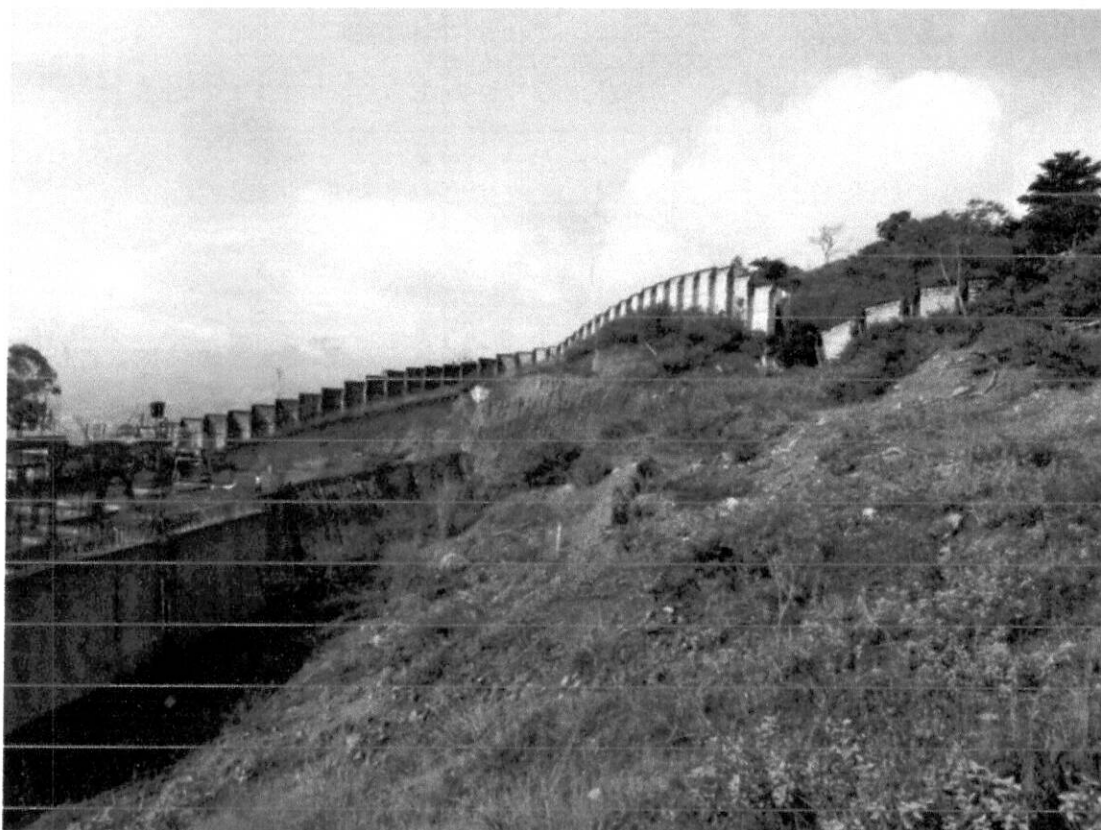
Panorámica área de estudio, a la derecha la masa de terreno inestable que se recuesta sobre el muro de contención provocando su falla y al fondo taludes de corte sin medidas de protección geotécnica.
