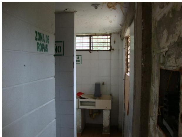
Figura 12. Degradación en elementos estructurales y arquitectónicos
