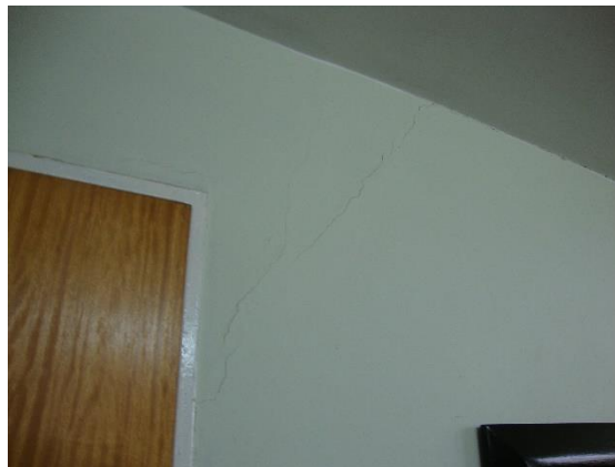
Imagen 12 Fisuras en muros divisorios
