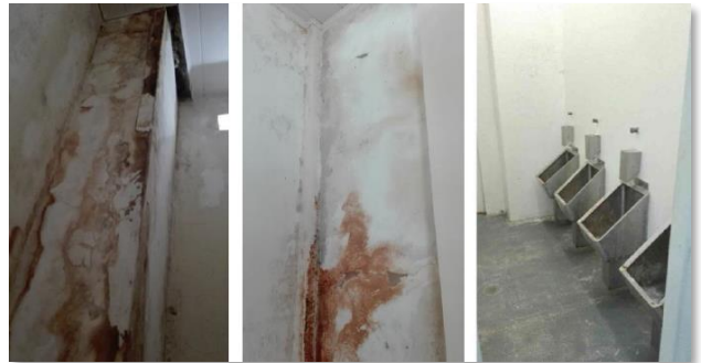
Deterioro por desuso
