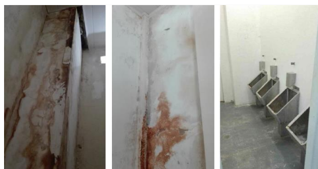
Deterioro por desuso
