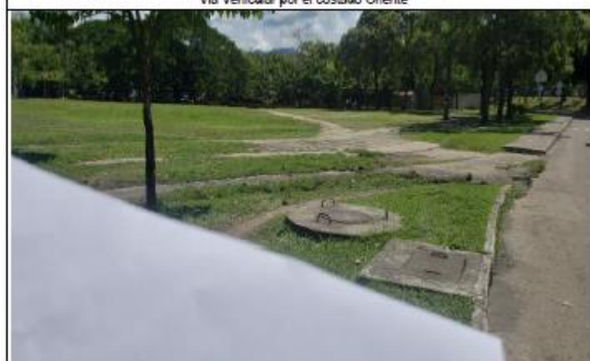
Cajas de inspección para recolección deguas lluvias y pozo de aguas residuales-costado Sur
