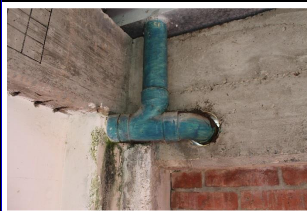
FOTO 13: Paso de Tuberías por Elementos Estructurales
