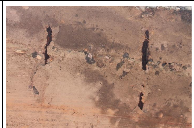
FOTO 14: Segregación del Agregado Grueso
