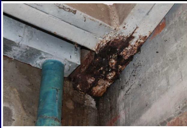
FOTO 11: Severa Corrosión En La Estructura De Cubierta
