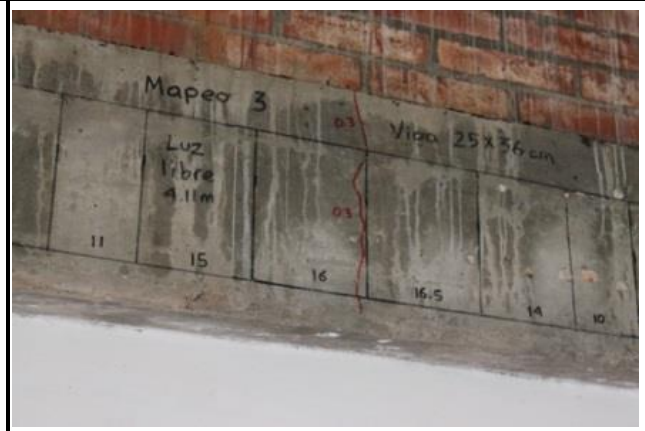
FOTO 10: Fisuras En Elementos
