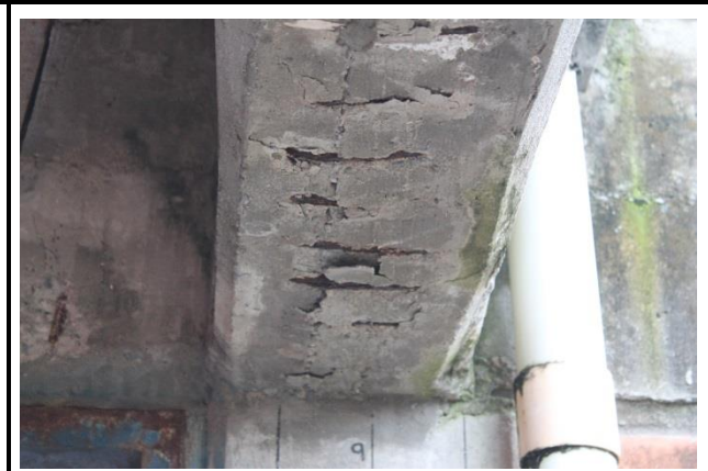
FOTO 12: Acero De Refuerzo Expuesto O Sin Recubrimiento
