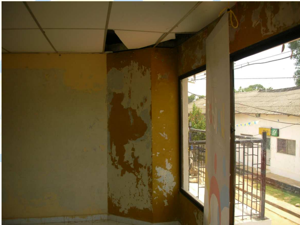
Fotografía No. 6- – Humedad muro interno fachada principal
