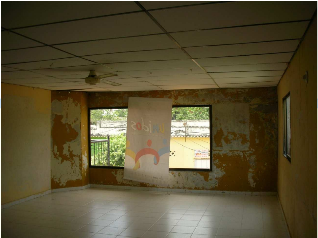
Fotografía No. 6- – Humedad muro interno fachada principal
