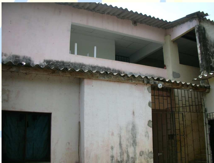
Fotografía No. 5 – Muro exterior – manchas humedad
