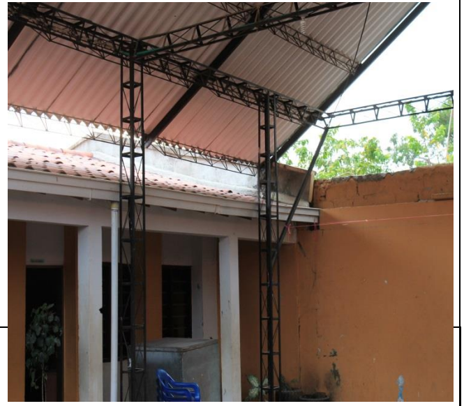
FOTO 14: Mal estado de las columnas y muros del patio.
