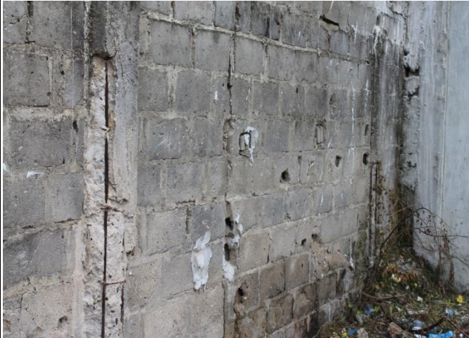
FOTO 5: Acero de refuerzo expuesto.
