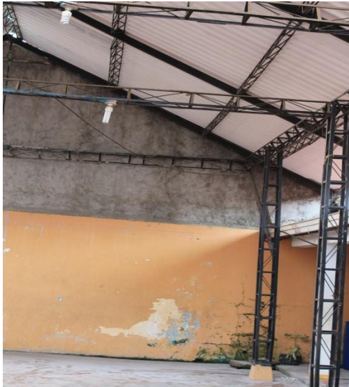
FOTO 15: Humedad en el muro del patio central.
