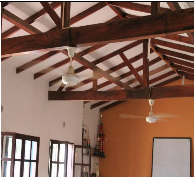
FOTO 19: Detalle de cercha en madera.
