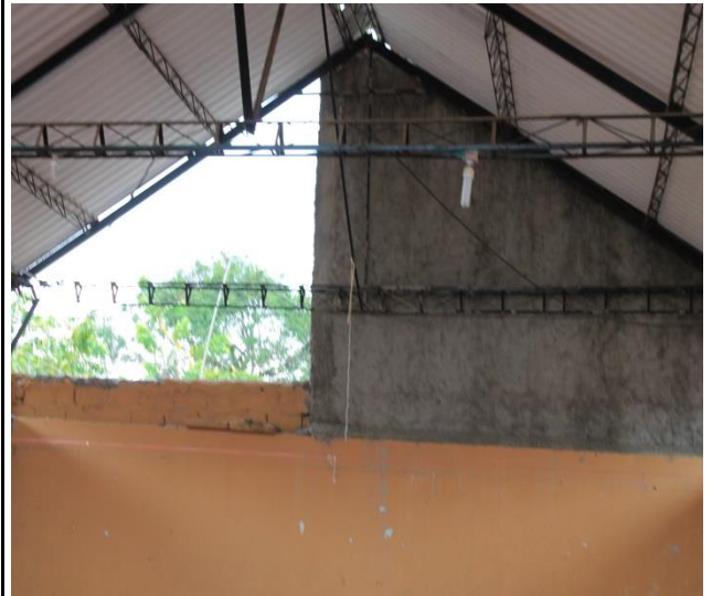
FOTO 10: Cuchilla en mampostería sin confinar.
