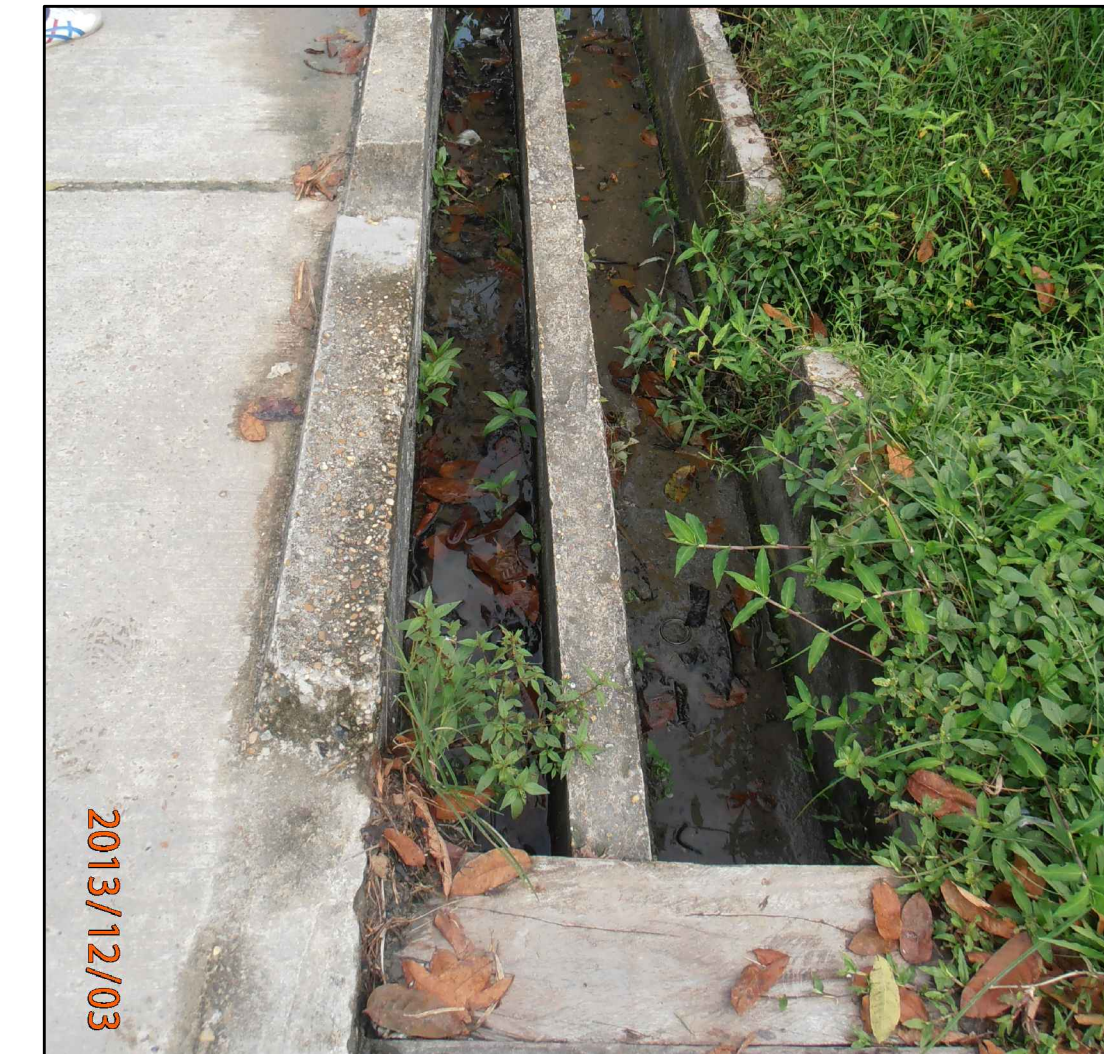
Canal aguas lluvias y aguas negras
