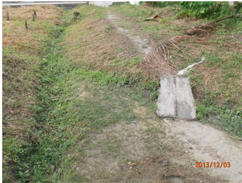
Drenaje aguas lluvias y aguas negras
