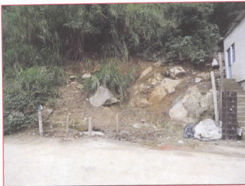
Fotografía 2. Ladera inestable por el sector occidental del lote.
