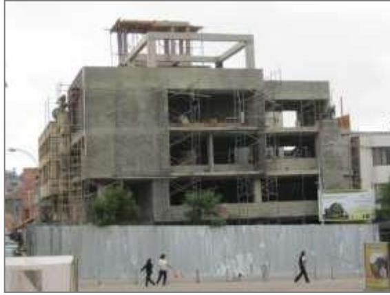
Pañetes externos fachada occidental.
