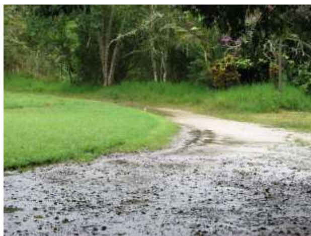
Imagen 3- Cancha en grama inundada por falta de drenajes y filtros para la evacuación de las aguas lluvias.
