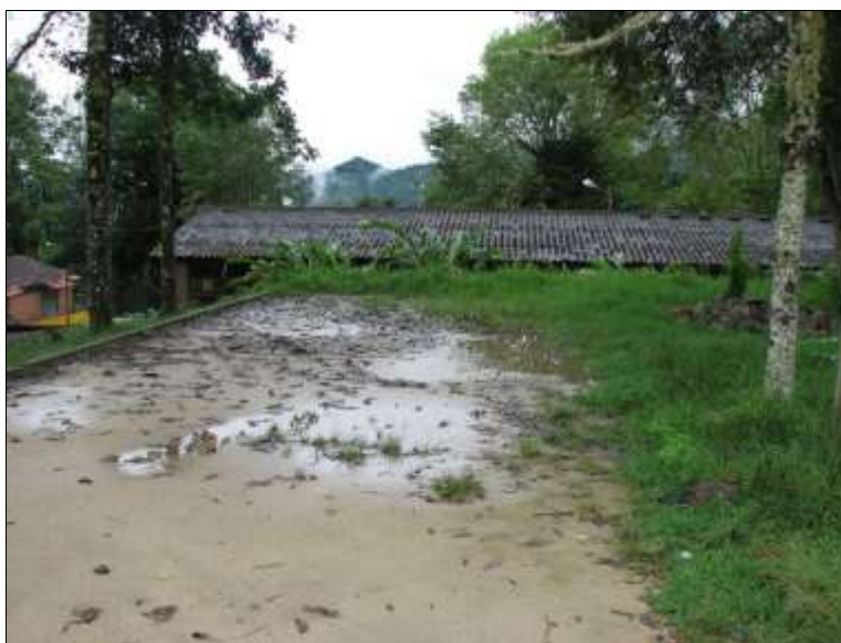
Imagen 6- Pista en arenilla y cuentas laterales sin desagües, ni filtros para la evacuación de las aguas lluvias.
