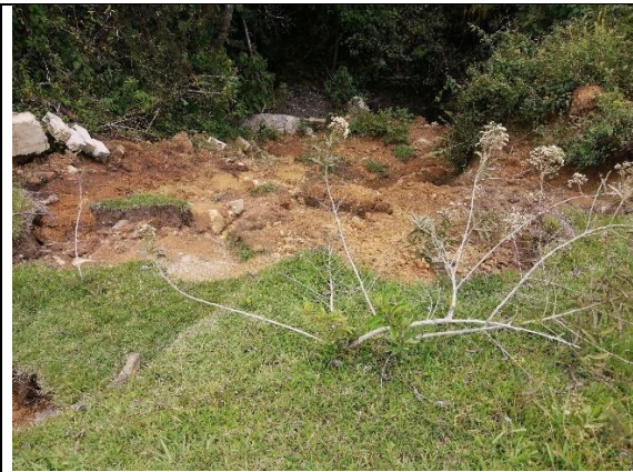
Deslizamiento hacia la quebrada La Gómez.
