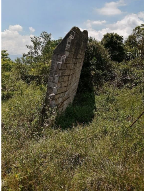
Inclinación del muro de cerramiento sector pola III.
