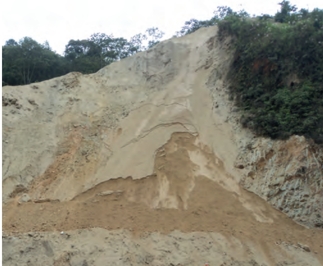
Pérdida de estabilidad lateral - material friable.
