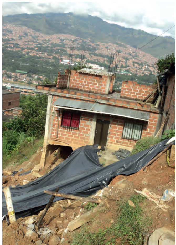
Estructura en riesgo.
