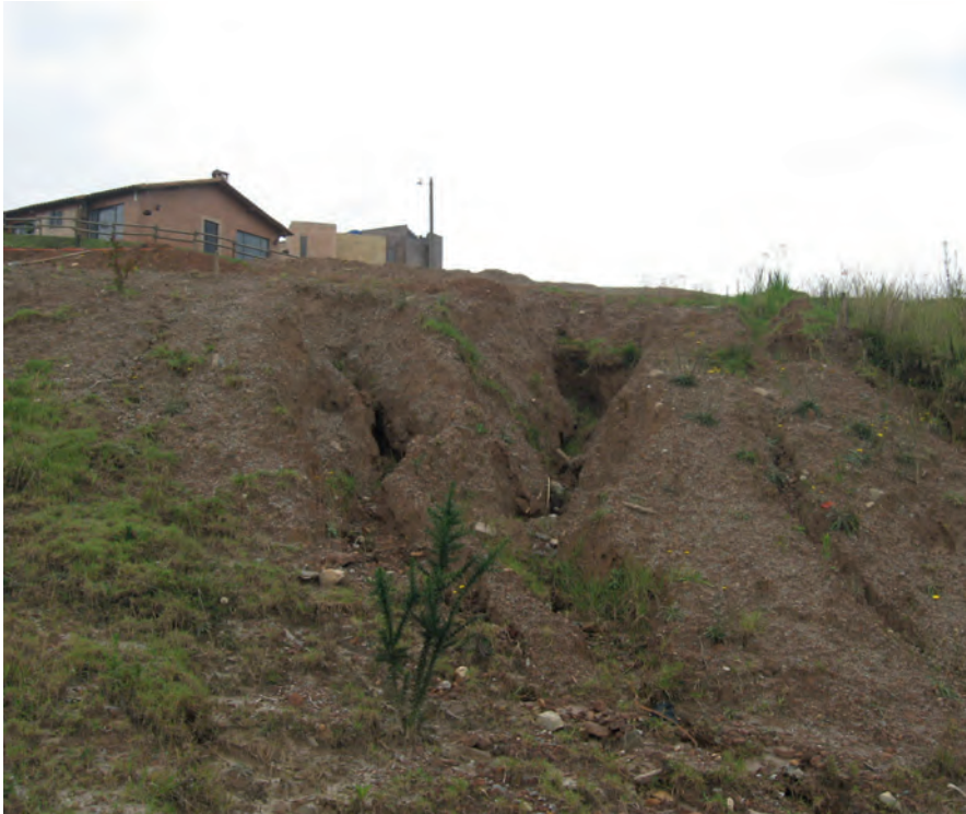
Erosión superficial cárcavas.
