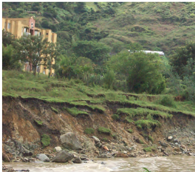
Inestabilidad lateral de las paredes del cauce.
