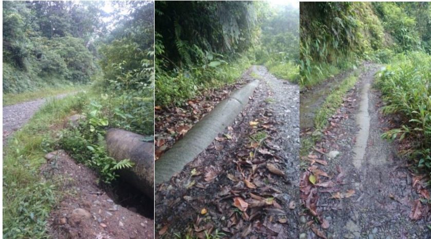
Figura 32. Tubería Visible, Semienterrada
