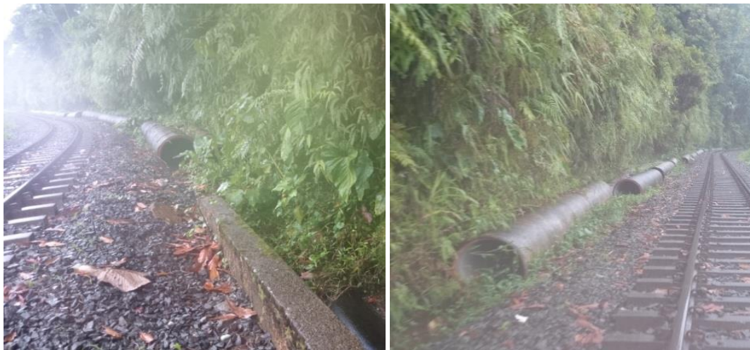
Figura 4. Tramos de tubería sin instalar.
