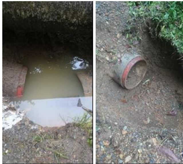
Figura 12. Accesorios sin instalar
