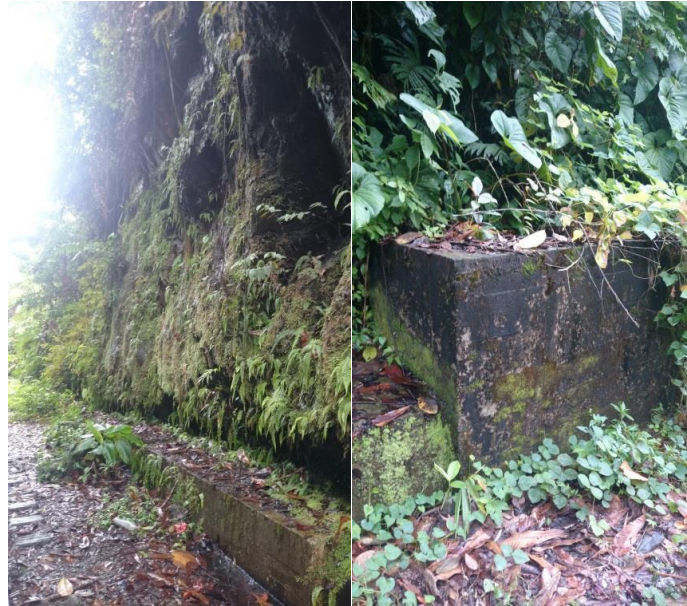
Figura 24. Tubería protegida por cárcamo en concreto
