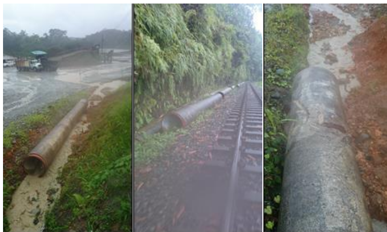
Figura 30. Tubería no instalada
