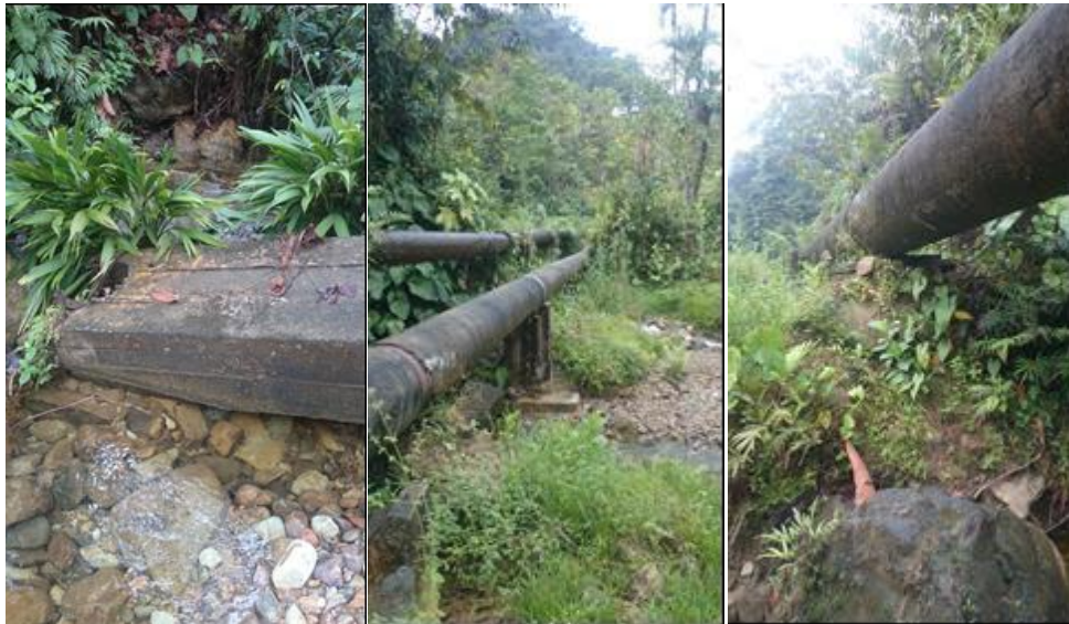
Figura 7. Paso elevado en mal estado.
