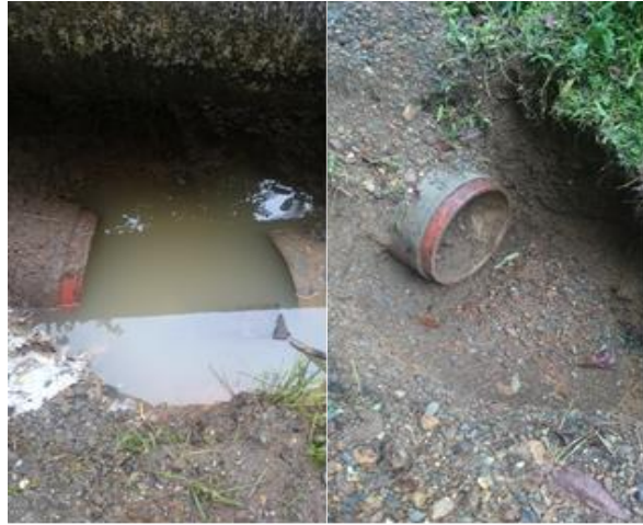
Figura 34. Accesorios sin instalar
