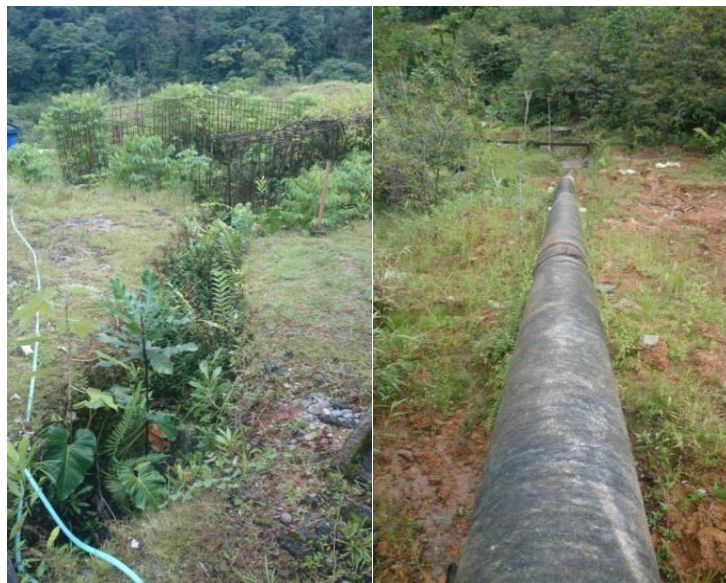
Figura 6. Salida de PTAP Escalerete, Tanque de Cloración
