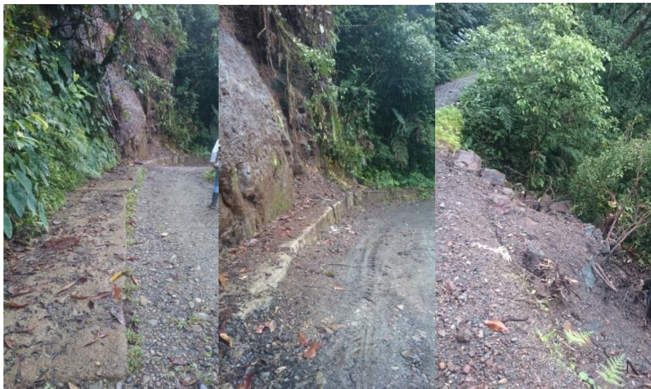
Figura 10. Deslizamiento sobre cárcamo
