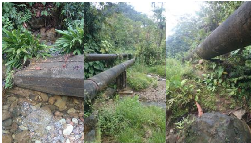
Figura 31. Paso elevado en mal estado
