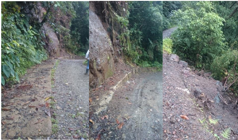
Figura 33. Deslizamiento sobre cárcamo
