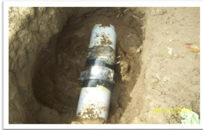
Figura N° 11 – Tubería de Conducción en PVC de 14"
