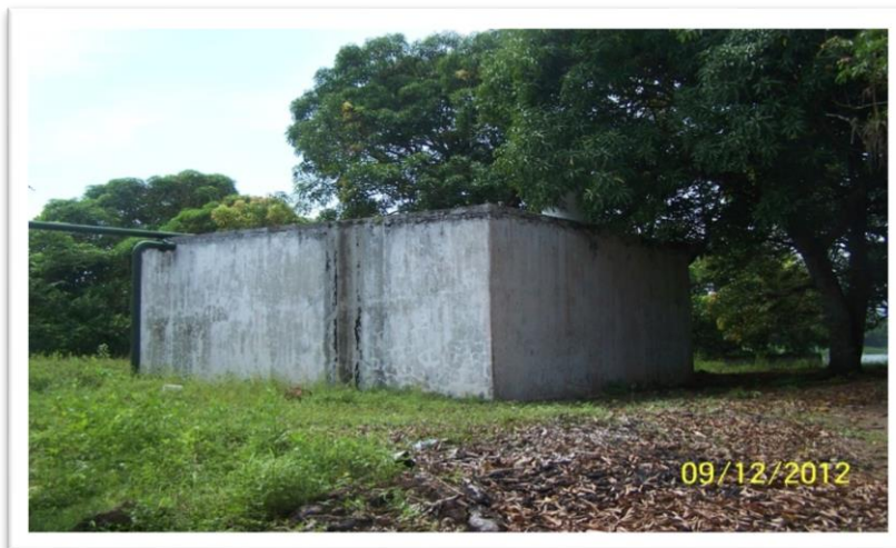
Figura N° 09 – Tanque superficial de almacenamiento de agua tratada
