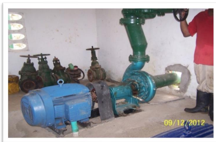
Figura N° 10 – Equipo Estación de Bombeo de agua tratada de 100 HP
