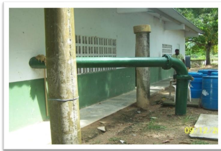
Figura N° 06 - Tubería de 8 pulgadas HF conducción de agua cruda hacia la PTAP existente
