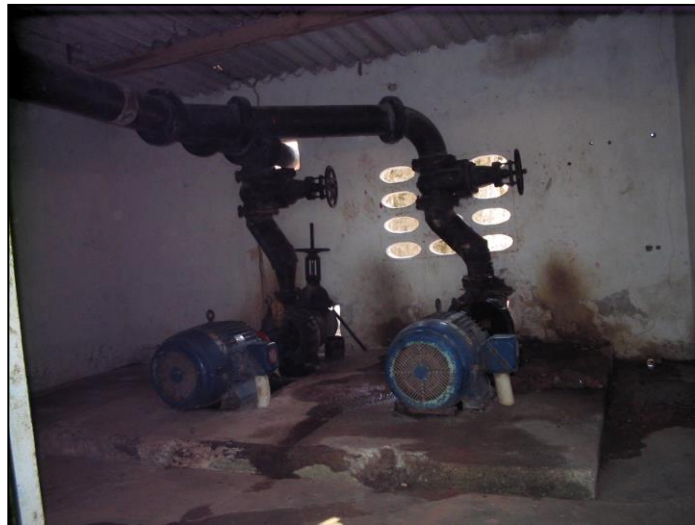
Figura N° 05 - Equipo de Bombeo de agua cruda.
