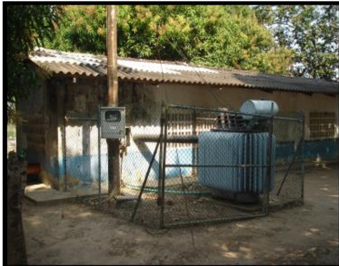
Figura N° 04 – Transformador de 400 KVA
