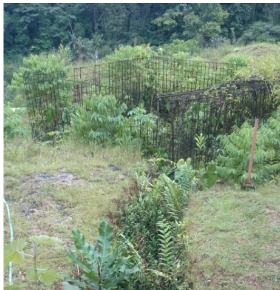
Figura 2. Tanque de Cloración sin terminar PTAP Escalerete
