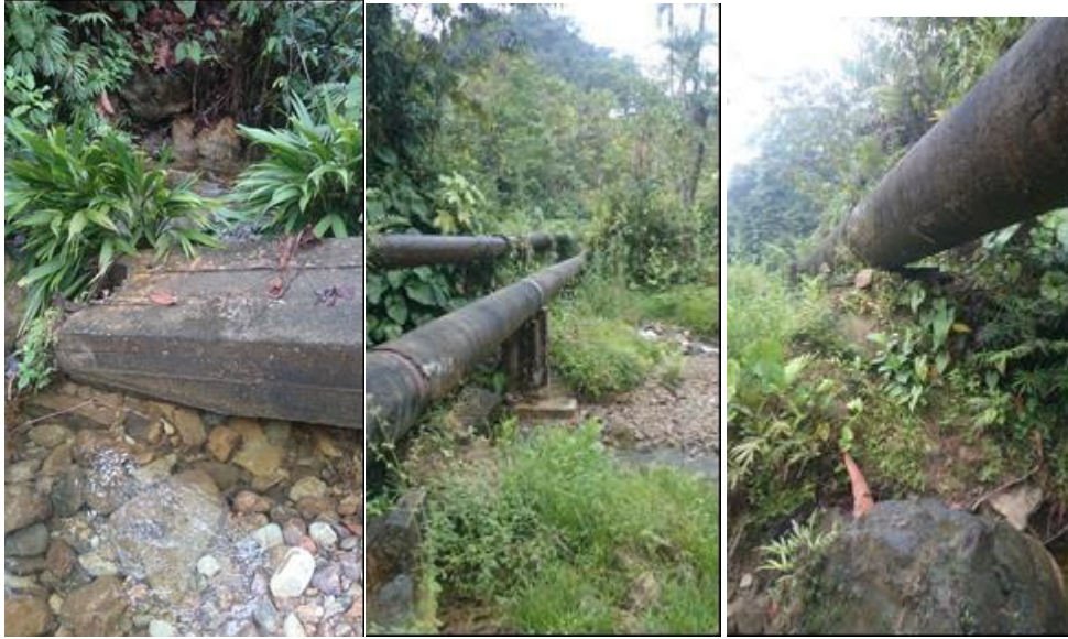
Figura 7. Paso elevado en mal estado.
