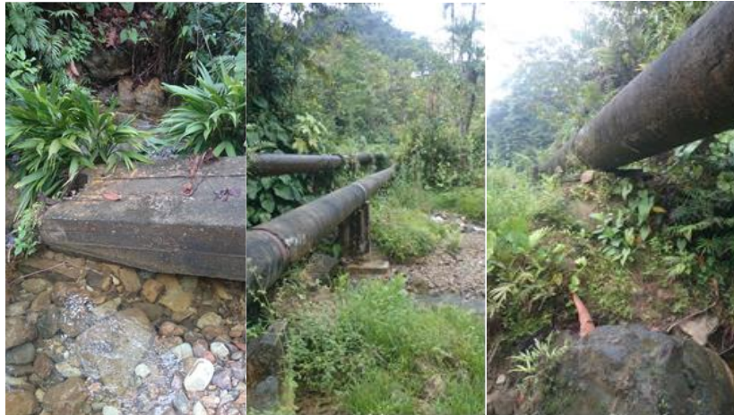
Figura 31. Paso elevado en mal estado
