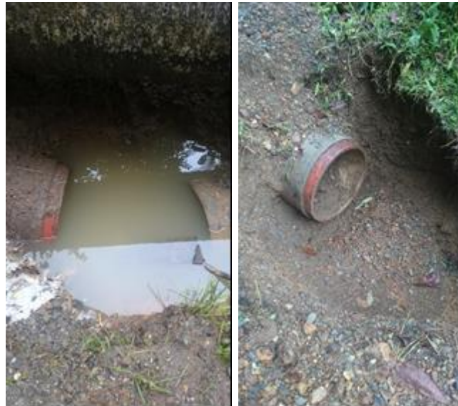
Figura 12 Accesorios sin instalar
