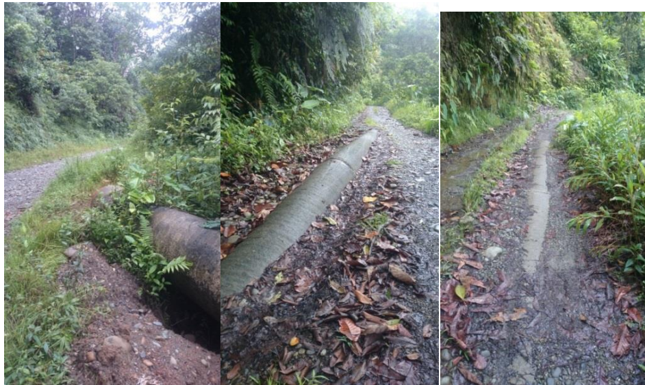
Figura 9. Tubería Visible, Semienterrada
