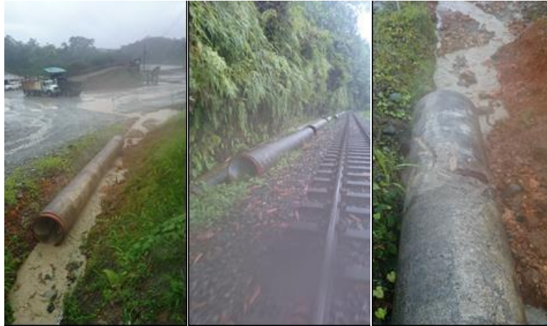
Figura 30. Tubería no instalada
