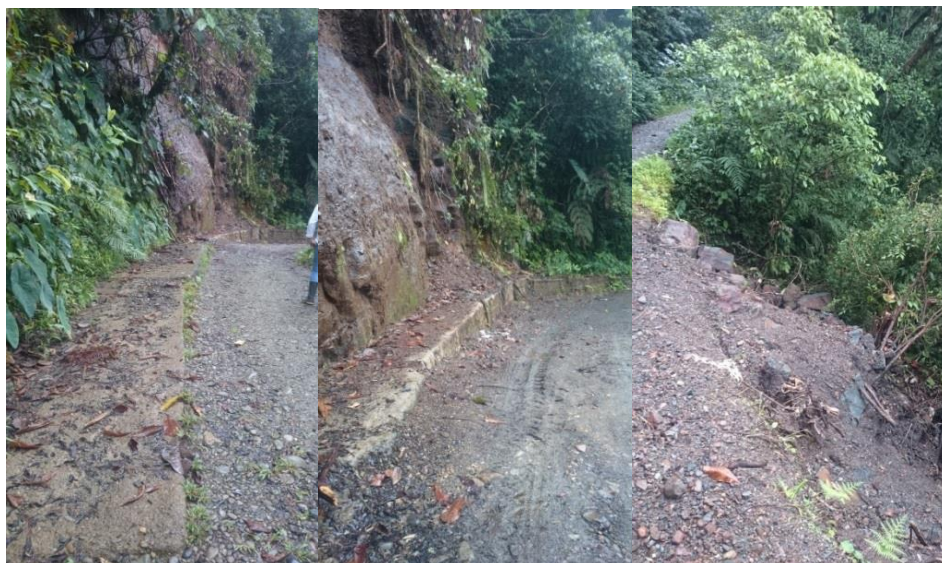
Figura 10. Deslizamiento sobre cárcamo
