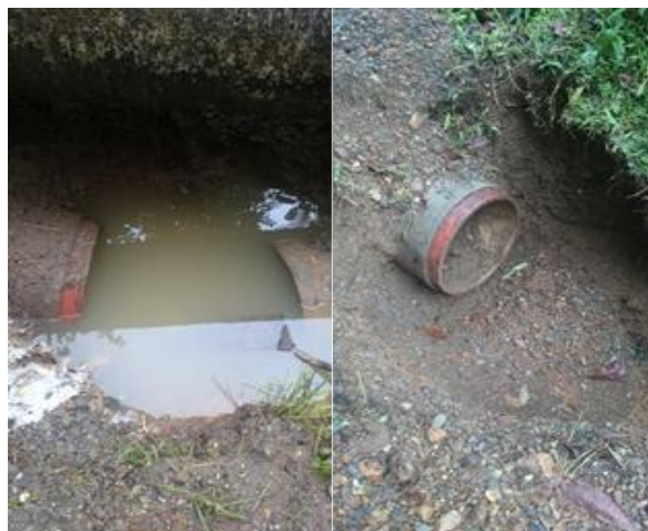
Figura 34. Accesorios sin instalar
