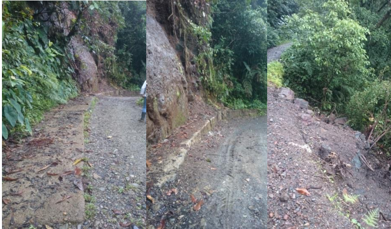
Figura 33. Deslizamiento sobre cárcamo
