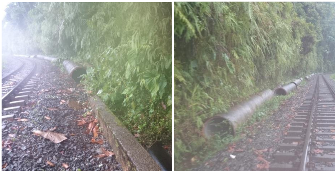
Figura 4. Tramos de tubería sin instalar.
