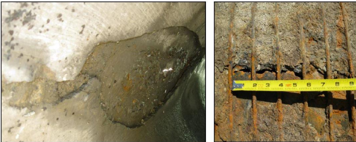
Figura 45. Ejemplo de deterioro en el CCP (fuente: Pure Technologies, 2014)
