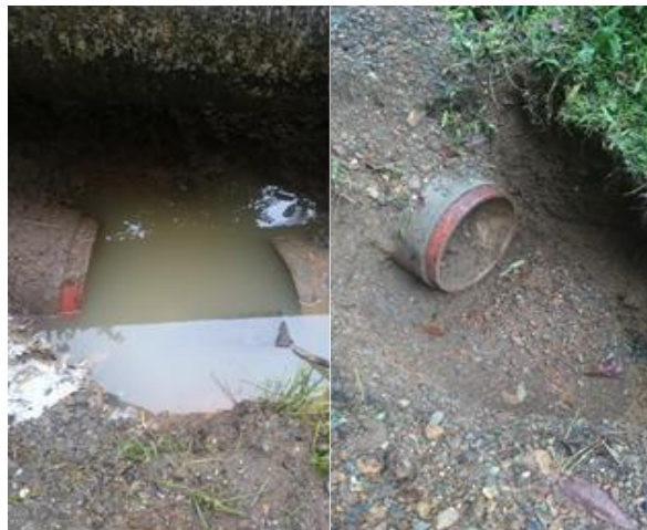
Figura 5. Accesorios sin instalar
