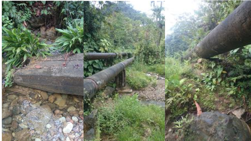
Figura 2. Paso elevado en mal estado
