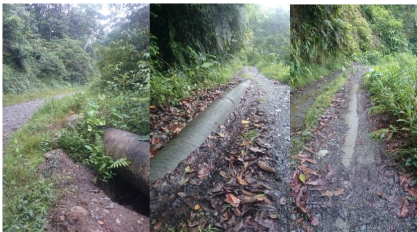
Figura 3. Tubería Visible, Semienterrada
