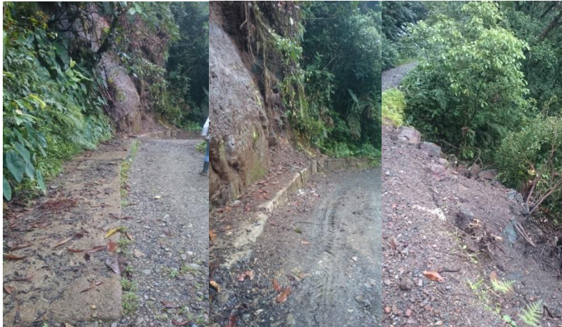
Figura 4. Deslizamiento sobre cárcamo
