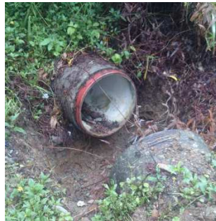
Codo sin instalar, posible punto de entrada para inspeccion
