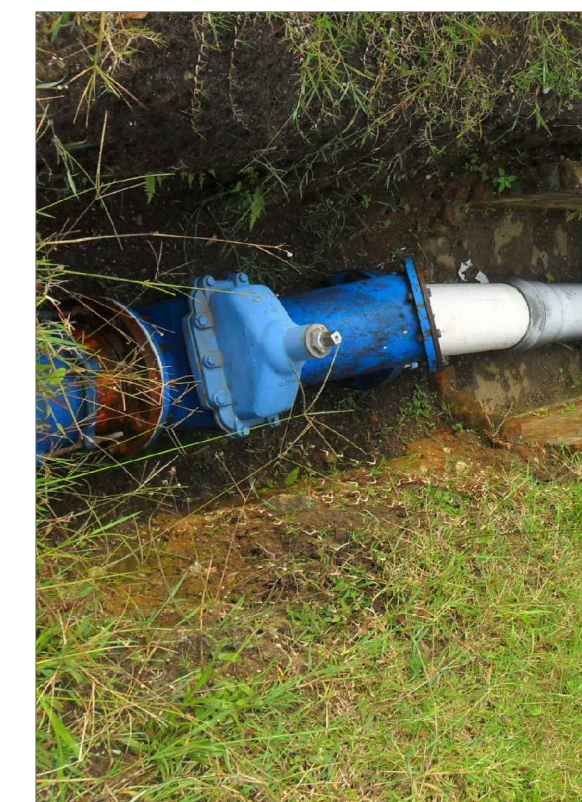
VISTA CAJA MEDIDOR
