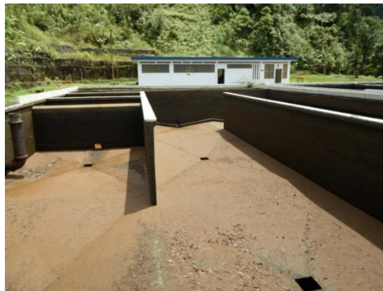
Ilustración No. 3 - Sedimentador convencional Línea 2 PTAP Escalerete
