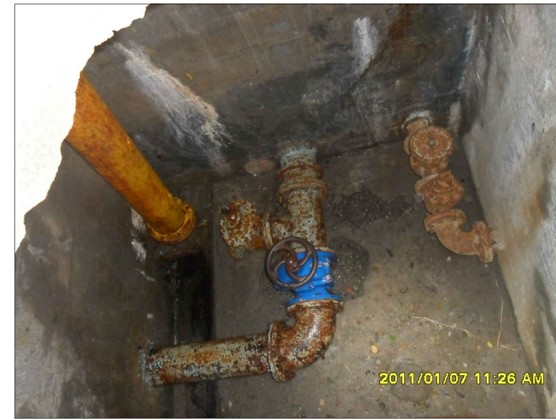
CAJA DE VÁLVULAS
