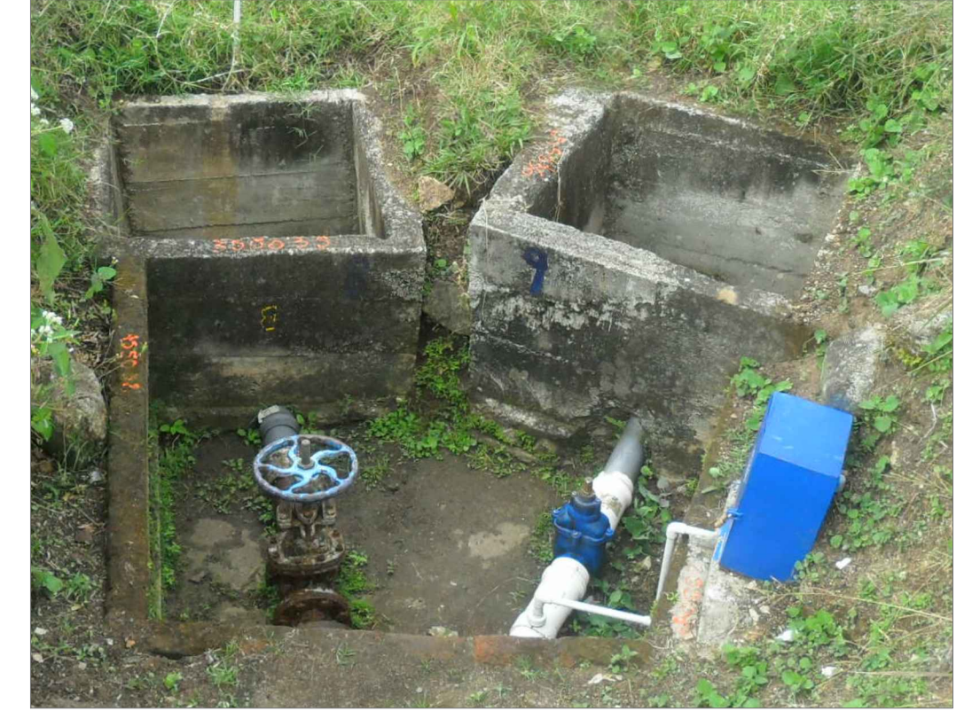
VISTA CAJA YEE DE REPARTICION
