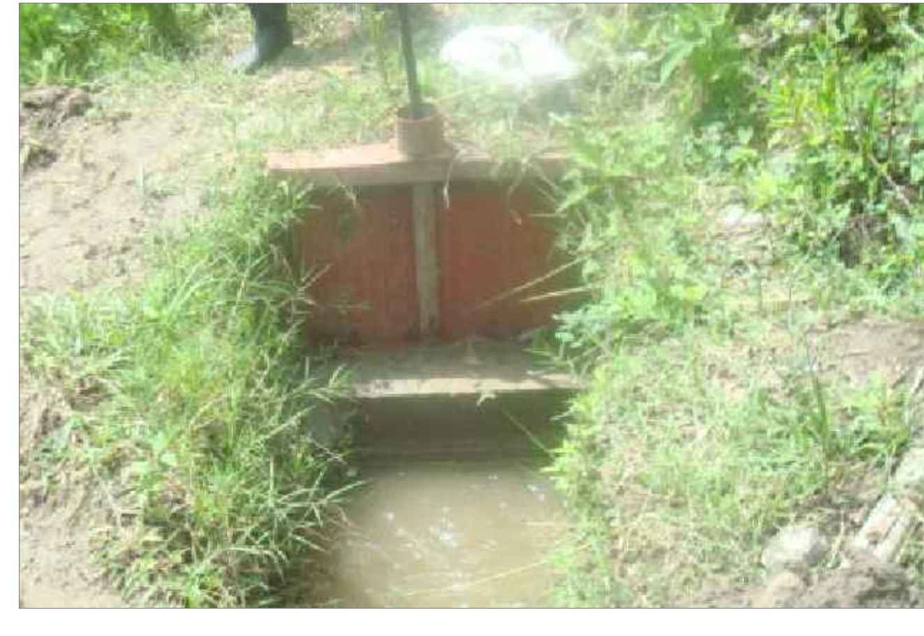
VISTA CÁMARA DE DERIVACIÓN
