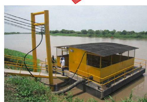
TOMA DE AGUA CRUDA EXISTENTE CON BARCAZA FLOTANTE
