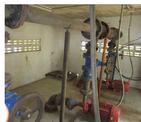
ESTACIÓN DE REBOMBEO "LA PUNTICA" Tres equipos bombas centrifugas con potencia de 20 HP y tamaño del impulsor 229 mm
