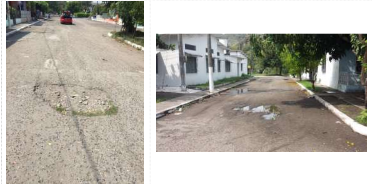
Figura 7: Daños causados por alcantarillado barrio Refugio
