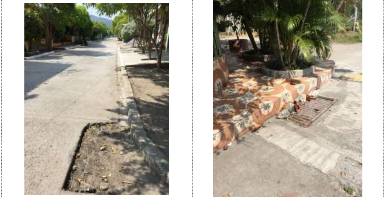
Figura 10: En estas líneas al igual que en el Refugio, las redes siendo de diámetros no mayores a 8", se han conectado múltiples sumideros, originando reboses constantes. Se observa en la imagen de la izquierda como la comunidad ha preferido volver a taponar los sumideros.
