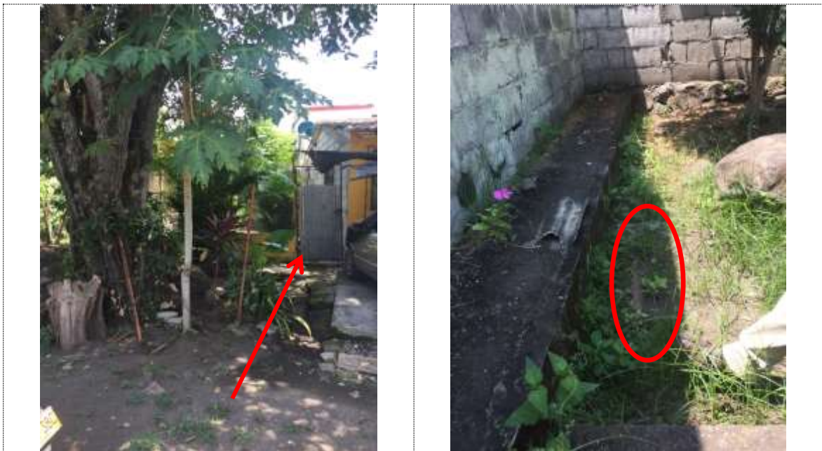
Figura 1: Redes expuestas a la intemperie y con fracturamiento por tal hecho, incluso algunas se trazan debajo de las viviendas allí localizadas.
