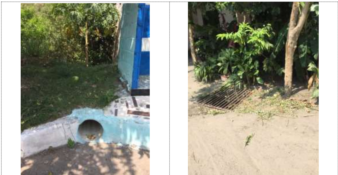
Figura 11: Se puede observar diferentes soluciones que se han dado en el lugar para poder evacuar las aguas lluvias y reducir el impacto en las zonas centrales del sector Ambalemita.
