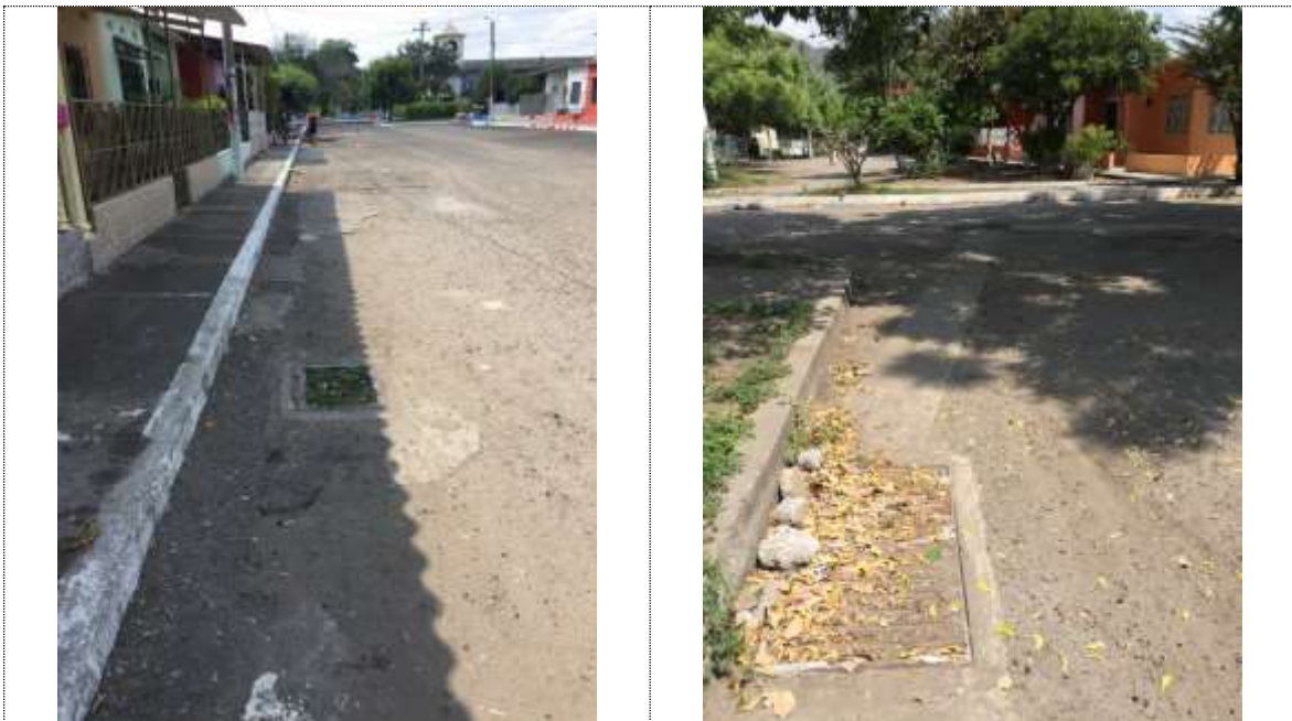
Figura 8: Sumideros contruidos y conectados al sistema sanitario original
