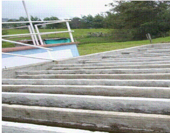
VISTA FLOCULADOR HORIZONTAL
