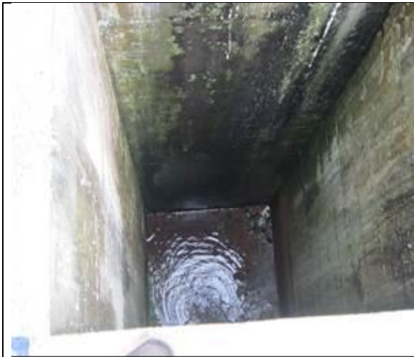
Vista de una de las celdas del sistema de floculación, se evidencia presencia de hongos en las paredes del mismo.
