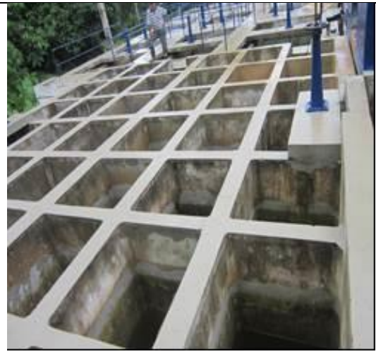
Vista general de las celdas que componen el sistema de floculación de la planta potabilizadora "nueva".
