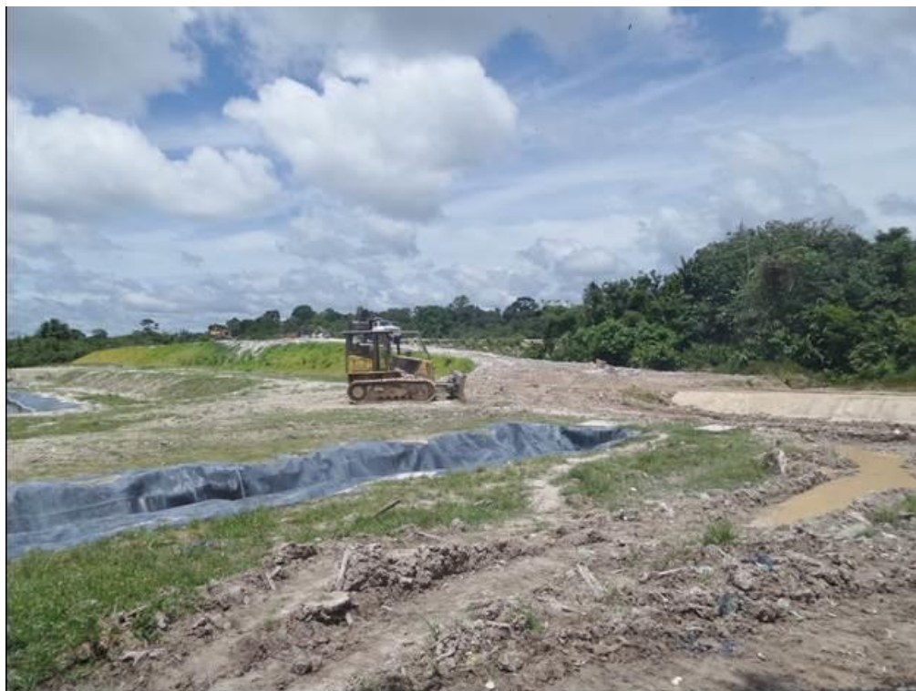
Foto 7. Encharcamientos de aguas lluvias fuera celda
