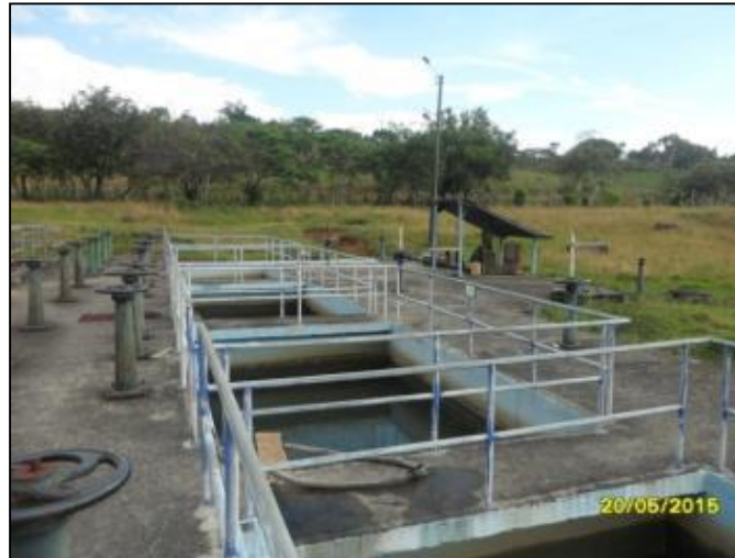
Imagen 4-7 Filtros PTAP Empresa EARPA
