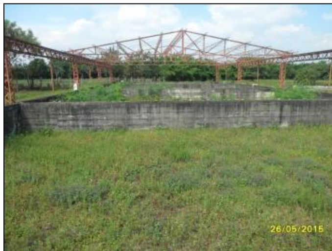
Imagen 4-16 Lechos de secado PTAR municipio de Guachené
