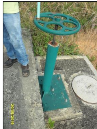
Válvula de salida del tanque
