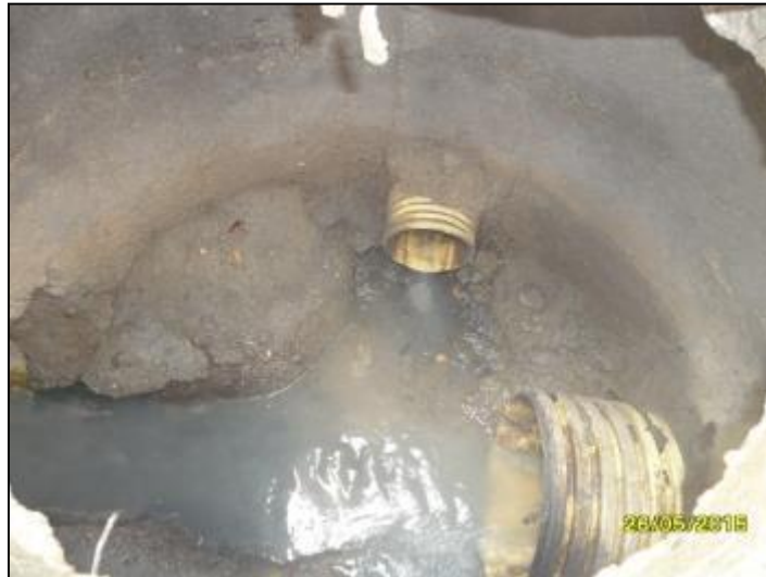
Imagen 4-12 Estado actual de la red de alcantarillado
