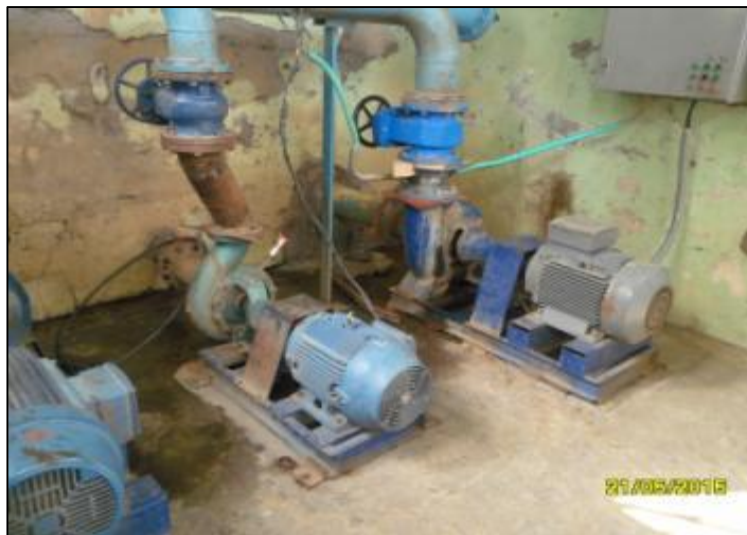
Imagen 2-3 Detalle sistema de bombeo implementado y estado del mismo
