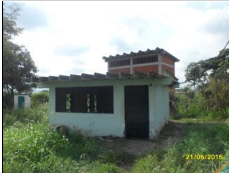
Imagen 2-2 Caseta estación de bombeo y al fondo antigua cámara de captación lateral con bombas sumergibles (fuera de servicio)
