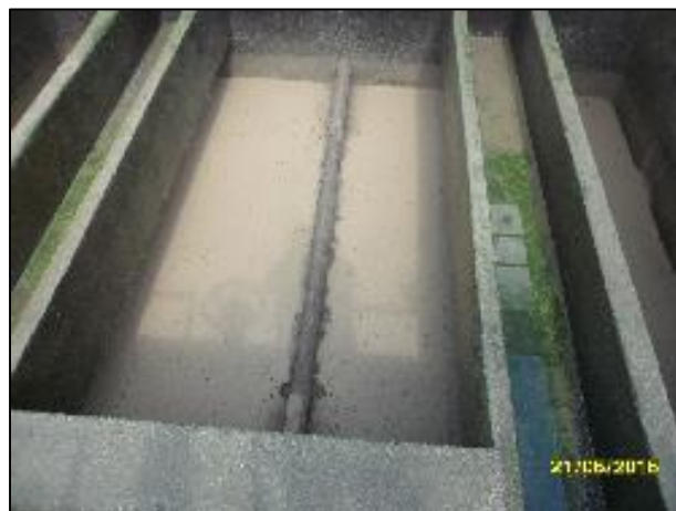
Imagen 2-13 Filtro en proceso de lavado
