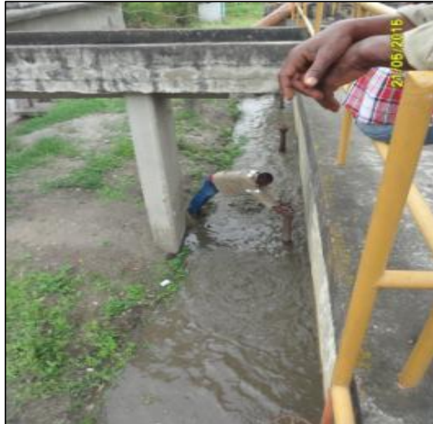
Imagen 2-6 Detalle lavado desarenador
