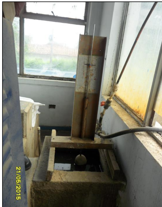
Imagen 2-7 Vertedero con flotaro para medición de caudal
