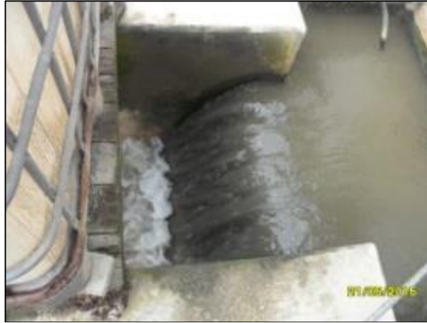
Imagen 2-8 Mezcla rápida – punto de dosificación sulfato de aluminio
