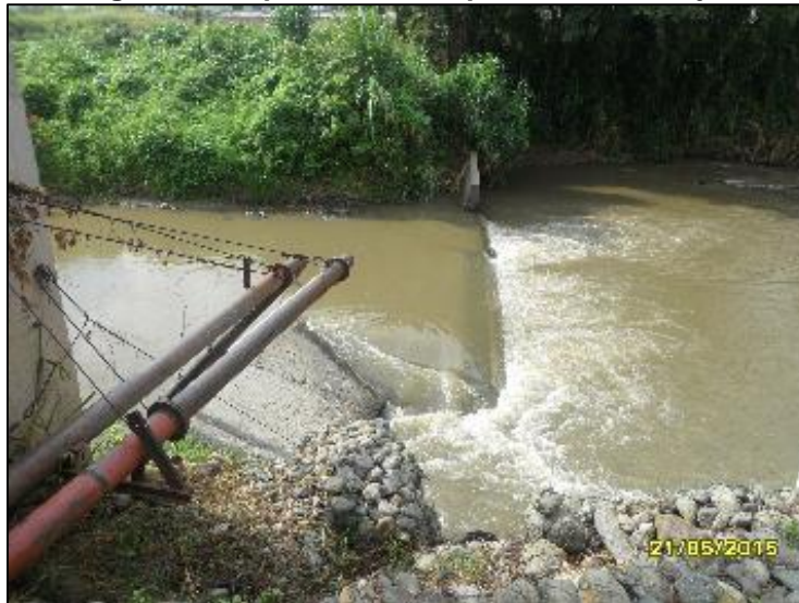
Imagen 2-1 Captación Municipio De Puerto Tejada
