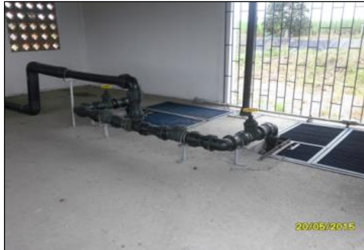
Imagen 1-13 Estación de Bombeo PTAR Municipio de Padilla
