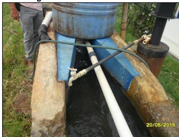
Imagen 1-5 Canaleta Parshall nueva
