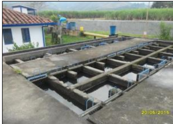
Imagen 1-8 Floculador hidráulico horizontal (compuertas de los Floculadores recién remplazadas por unas nuevas)
