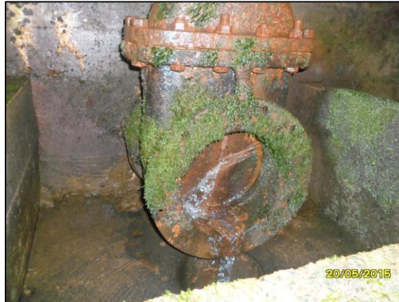
Imagen 1-6 Válvula con fuga y sin mantenimiento en lavado filtros lentos
