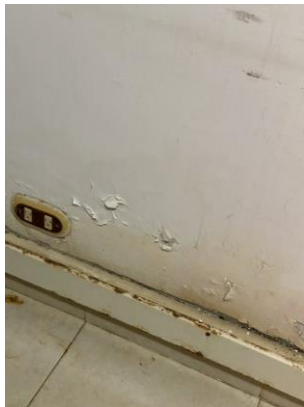
Canaletas metalicas oxidadas
