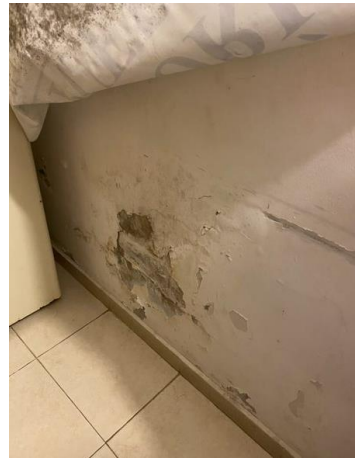
Humedad en la parte trasera del lavadero
