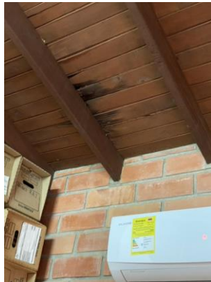
Humedad en cubierta
