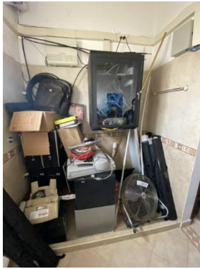
Cuarto de UPS
