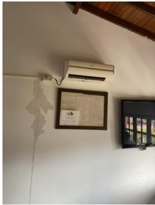
Pared en mal estado despacho defensor
