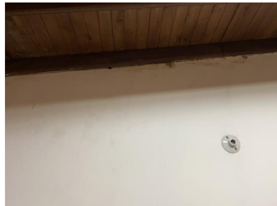
Humedad en la parte superior de la pared
