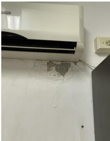
Pared con humedad
